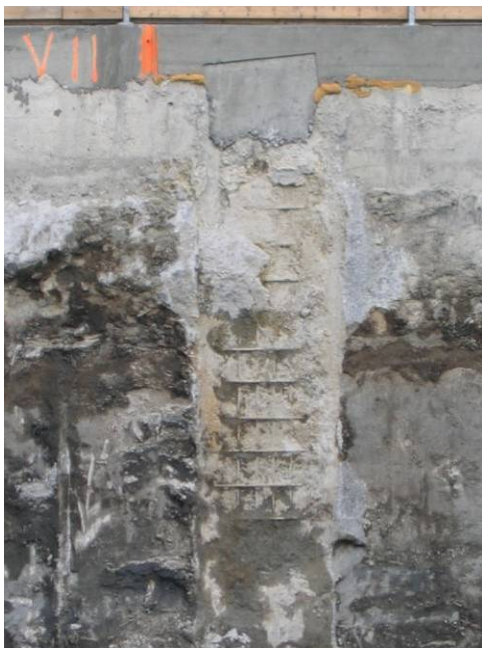
Fig 5.17 - Skade på betong etter endesteng
