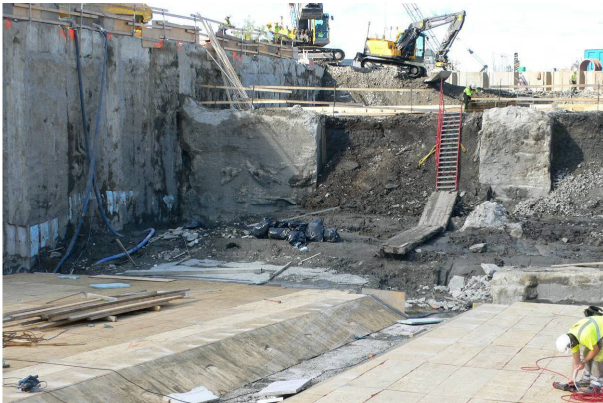
Fig 7.3 – Graving ned til takplate
