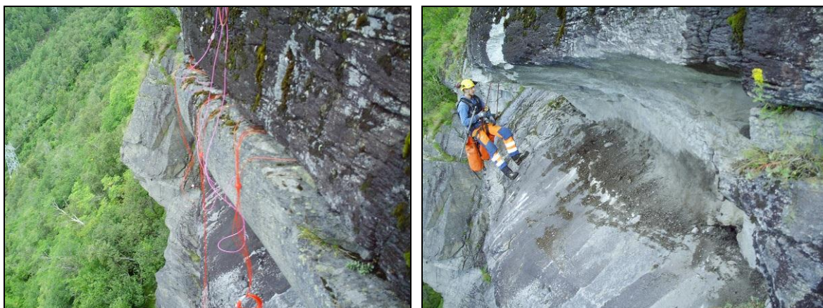
Figur 5.4 Nedspregning av steinblokk (før/etter) i fjellsiden ved rv. 70 Oppdølsstranda (Foto: Betongrenovering Drift AS)
