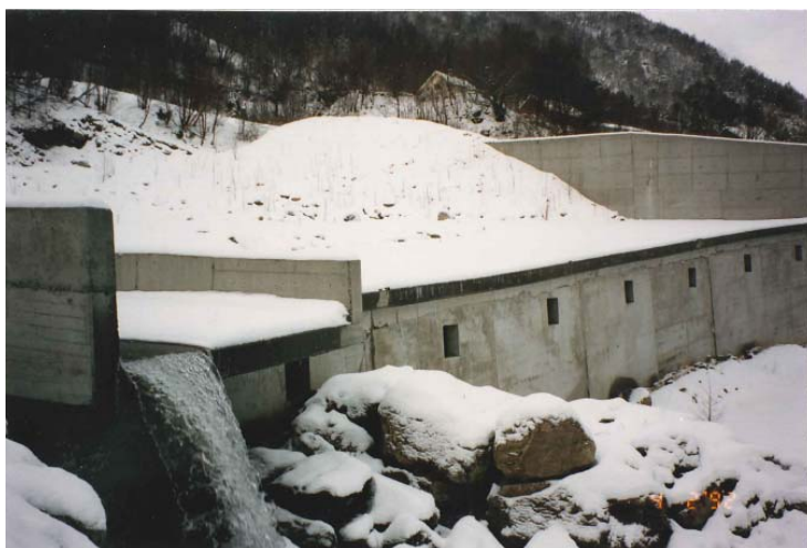
Figur 8.7. Eksempel på skredoverbygg hvor vannet føres over taket av overbygget i en vannrenne og hvor området nedenfor vannrenna er erosjonssikret. (Foto: H. Norem)
