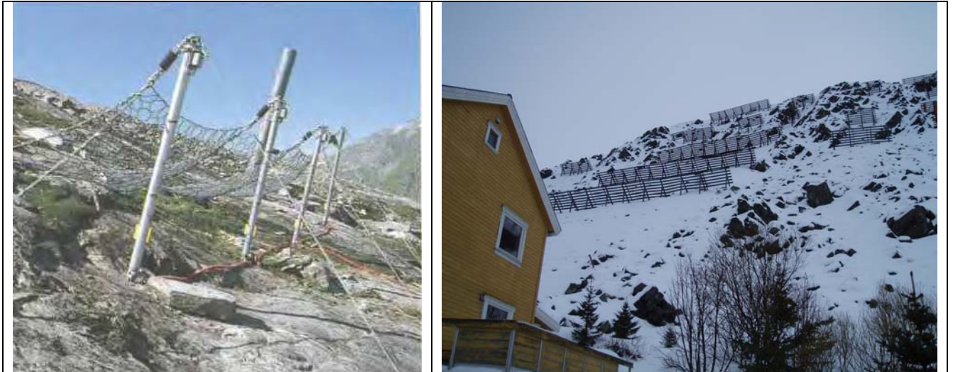
Figur 8.10. Eksempler på støtteforbygninger mot snøskred. Til venstre nettkonstruksjon og til høyre forbygning av stål. (Foto: J. O. Larsen og H. Norem)
