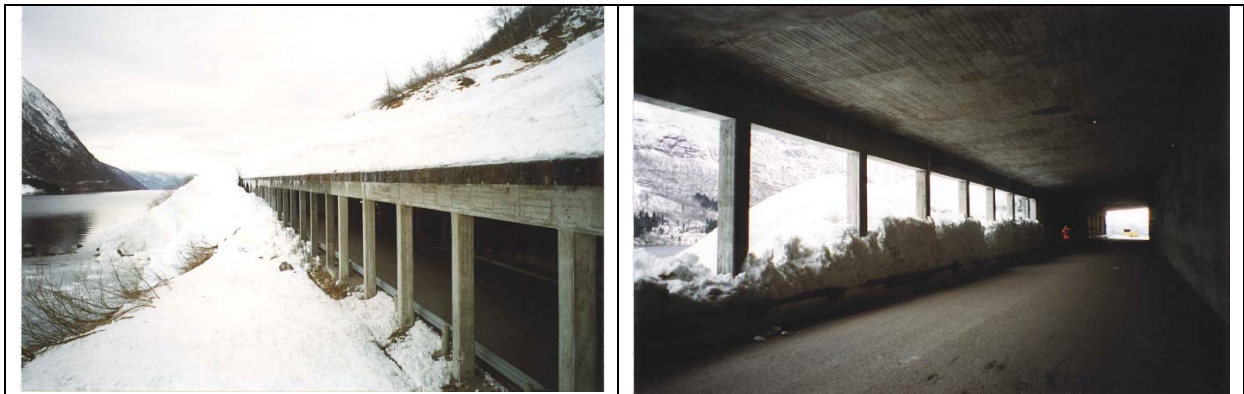
Figur 8.4 Foto av overbygg med åpen frontvegg, og hvor skredsnø har trengt inn i overbygget. Rv 13, Ramsteina, Sogn og Fjordane (Foto: H. Norem)
