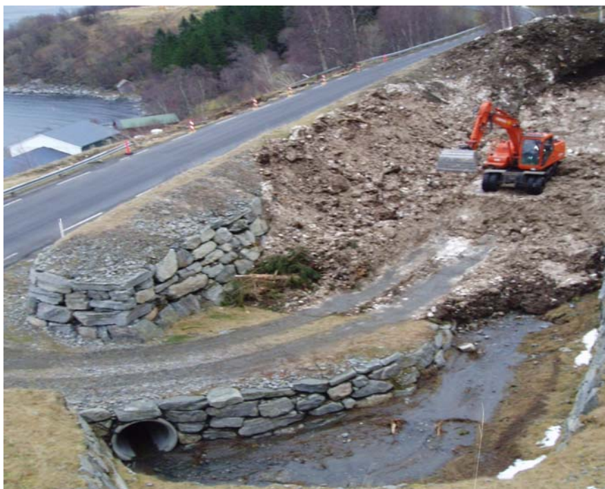
Figur 8.23. Kombinert buet voll og fangvoll hvor innløpet til reserve stikkrenne er plassert til side for vollen og beskyttet for å bli tett av skredmasser. E39, Storegjølet, Møre og Romsdal. Foto: H. Norem)
