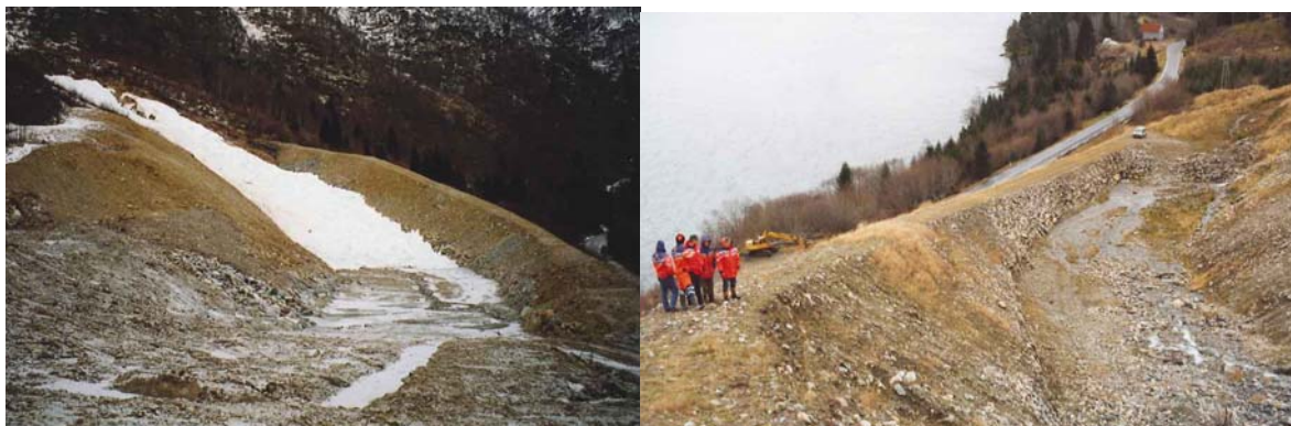
Figur 8.18. Eksempel på ledevoll for sikring mot snøskred og sørpeskred. Vollkrona er dessverre ikke bygget med jamn stigning i øvre delen av vollen, og på dette partiet har skred gått over vollen, Sandvika, Sogn og Fjordane (Foto: Harald Norem)
