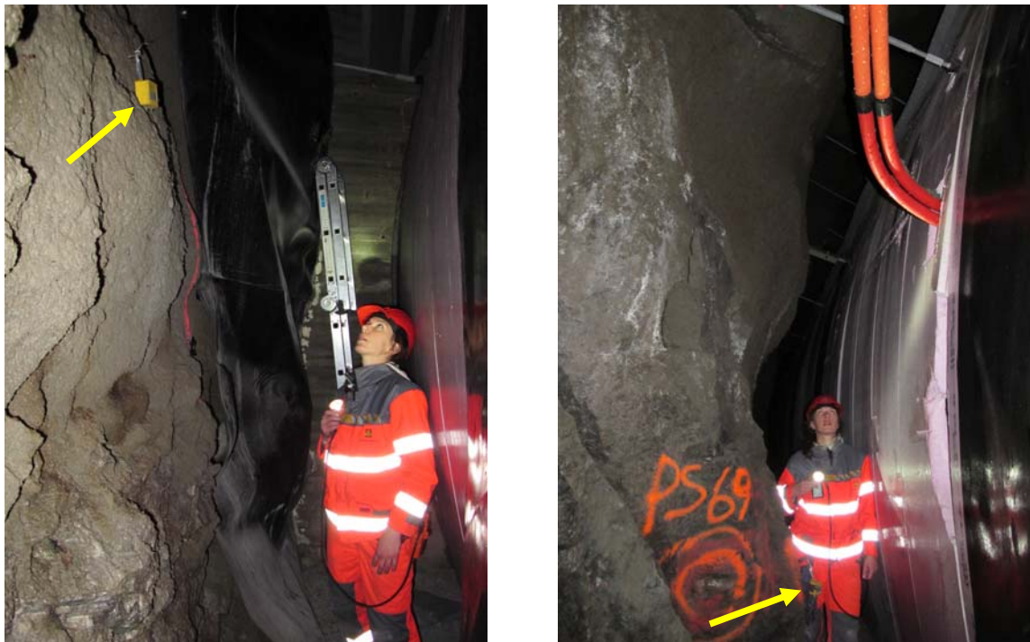
Figur 3 Tinytag Plus temperaturmålere montert i bergrommet, hhv. nær portal (t.v.) og nær nisje (t.h.). Temperaturloggerne er markert med gul pil.
