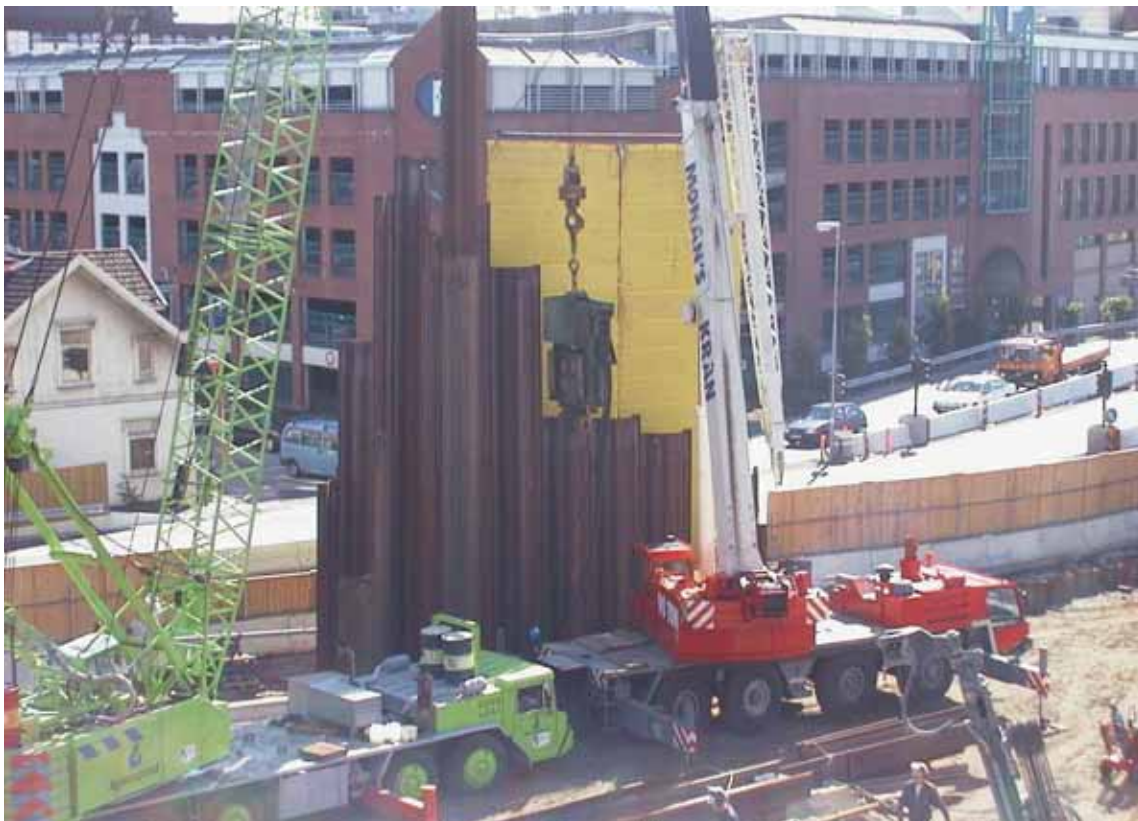
Figur 18.4 Støyskjermende tilta E 18 Kristiansand, Banehagen tunnelportal
