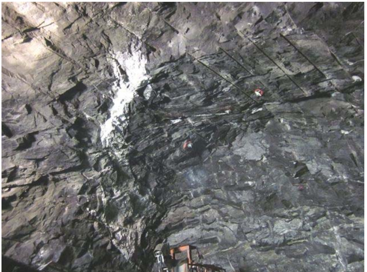
Øvre venstre side 2.salve ca.profil 857,5-863, noen mindre utfall og manglende halvpiper.
