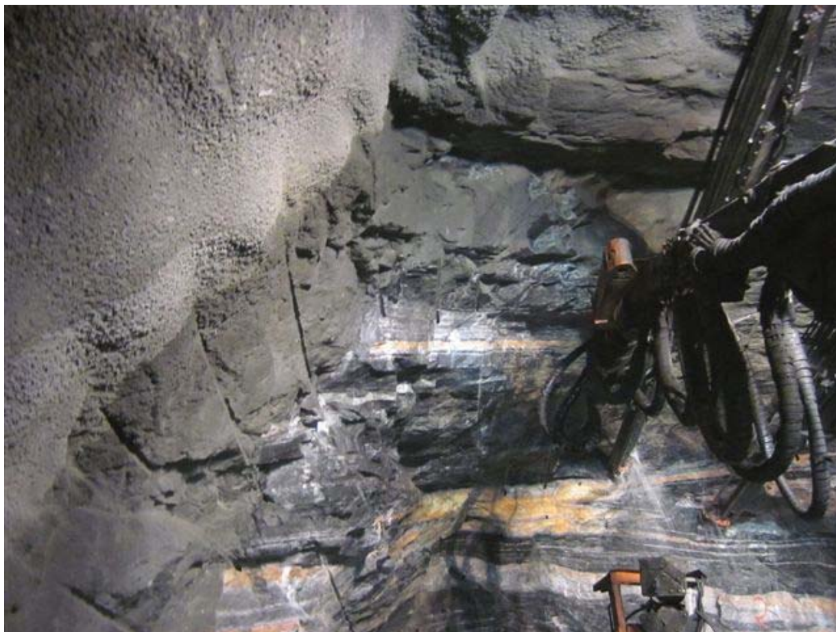
Øvre venstre side av 7.salve 878-83, båndet gneis. Utfall (svart) øverst etter nevnte leirsleppe, også utfall innerst grunnet kombinasjon(?) sprekker/sprikende hull.
