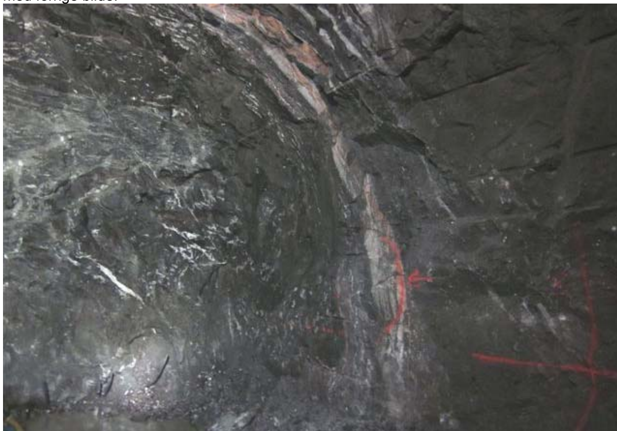
Høyre side 8.salve 883-88, samt halve 7.salve. Lite med gjenstående borpiper i veggen, men det er noen. En knøl er antydnet med rødt(?), men det var allikevel ingen omskyting her etter lasting. Mulig ble denne tatt med på neste salve (bilde er tatt før boring av annet enn sålehull), evt var veggen allikevel utenfor teoretisk profil.
