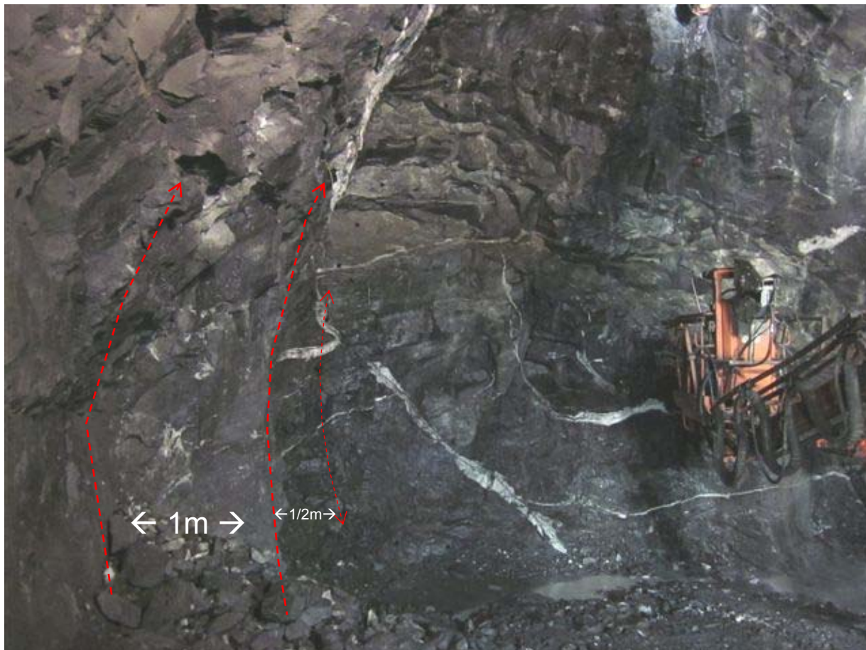
Venste vegg med for store hakk, omtrent 1 meter fra salve 1 til salve 2 grunnet unøyaktighet både ansett og stikning kombinert med boravvik, omtrent halvparten fra vegg til konturhullene i neste salve (3.salve).
