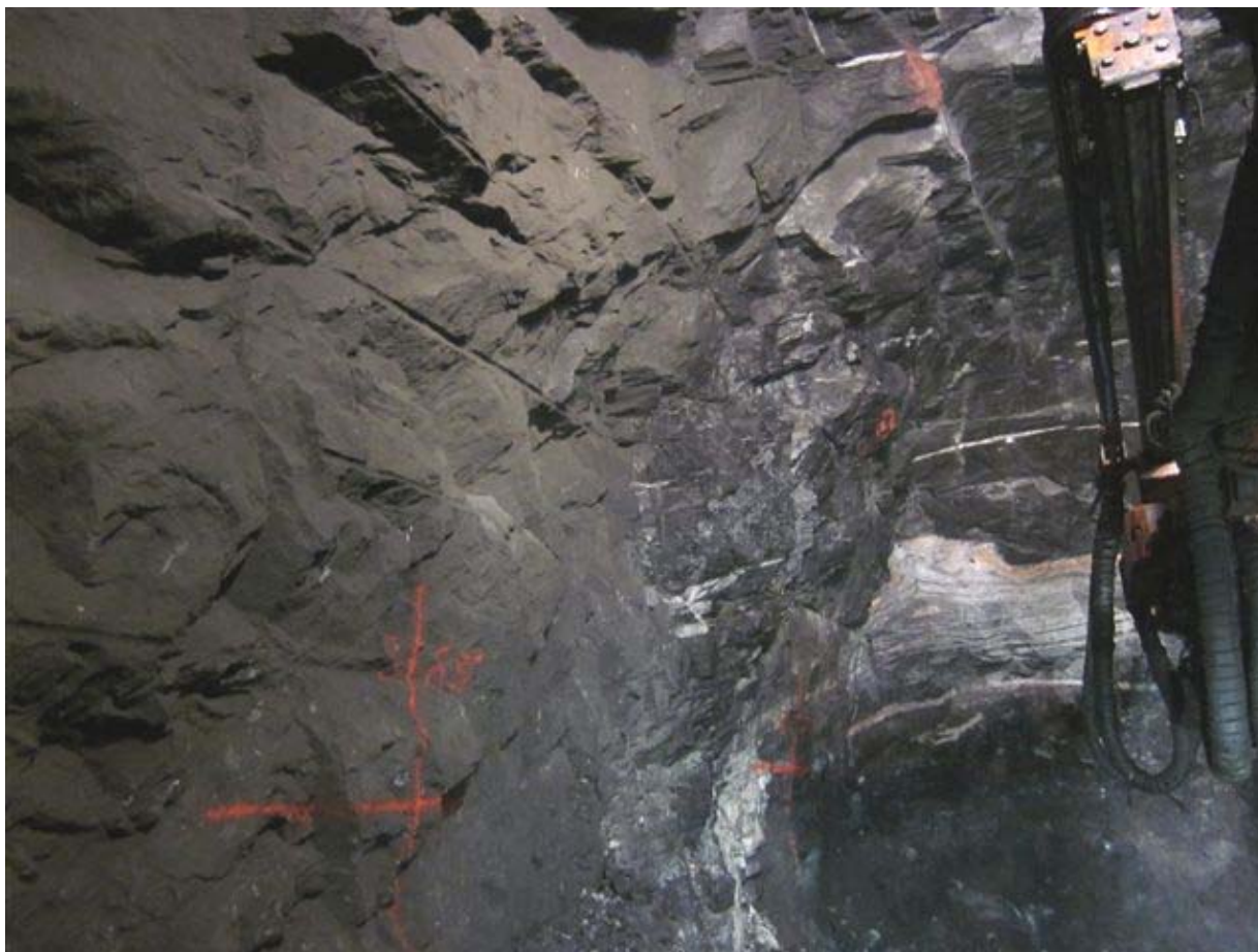
Overgangen 4. til 5.salve; det er på venstre side i tunnelen stadig tydelige hakk i salveskjøten, mens høyresiden jevnt over er jevnere. Lys gneis med marmor skimtes i stoffen. c/c=0,7 og 3 kg slurry/hull gir ikke spesielt jevn kontur.
