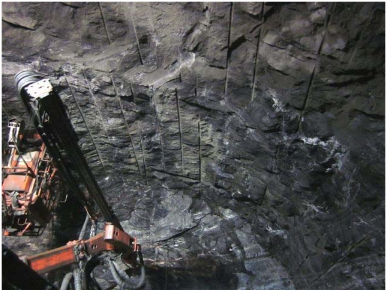
Heng og høyre side 13.salve ca.profil 909-914. To konvergerende hull midt i hengen skyldes boravvik høyre hull, ansett var rett.
