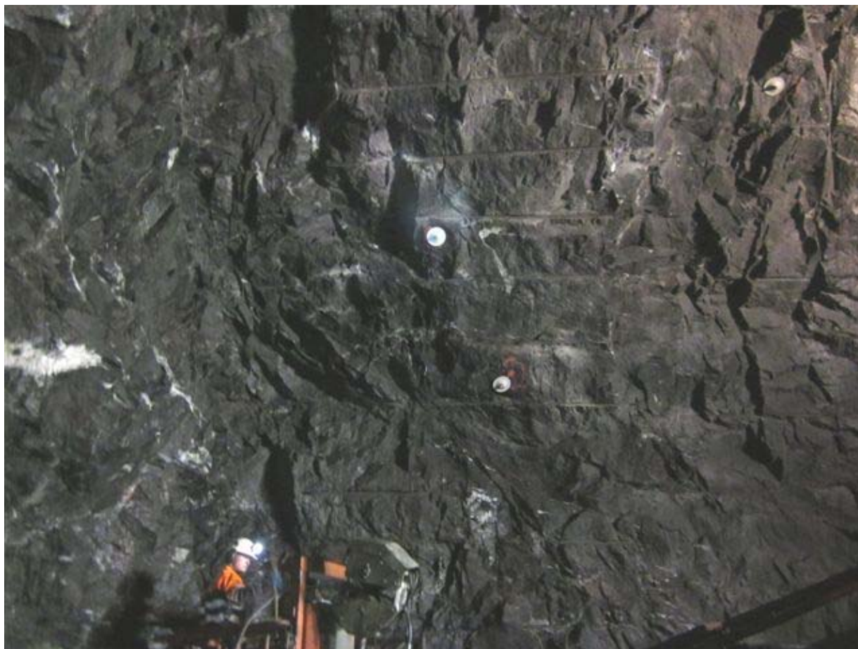
Høyre vegg/vederlag ca.profil 857,5-863. Utfall etter foliasjon og sekundærsprekker.
