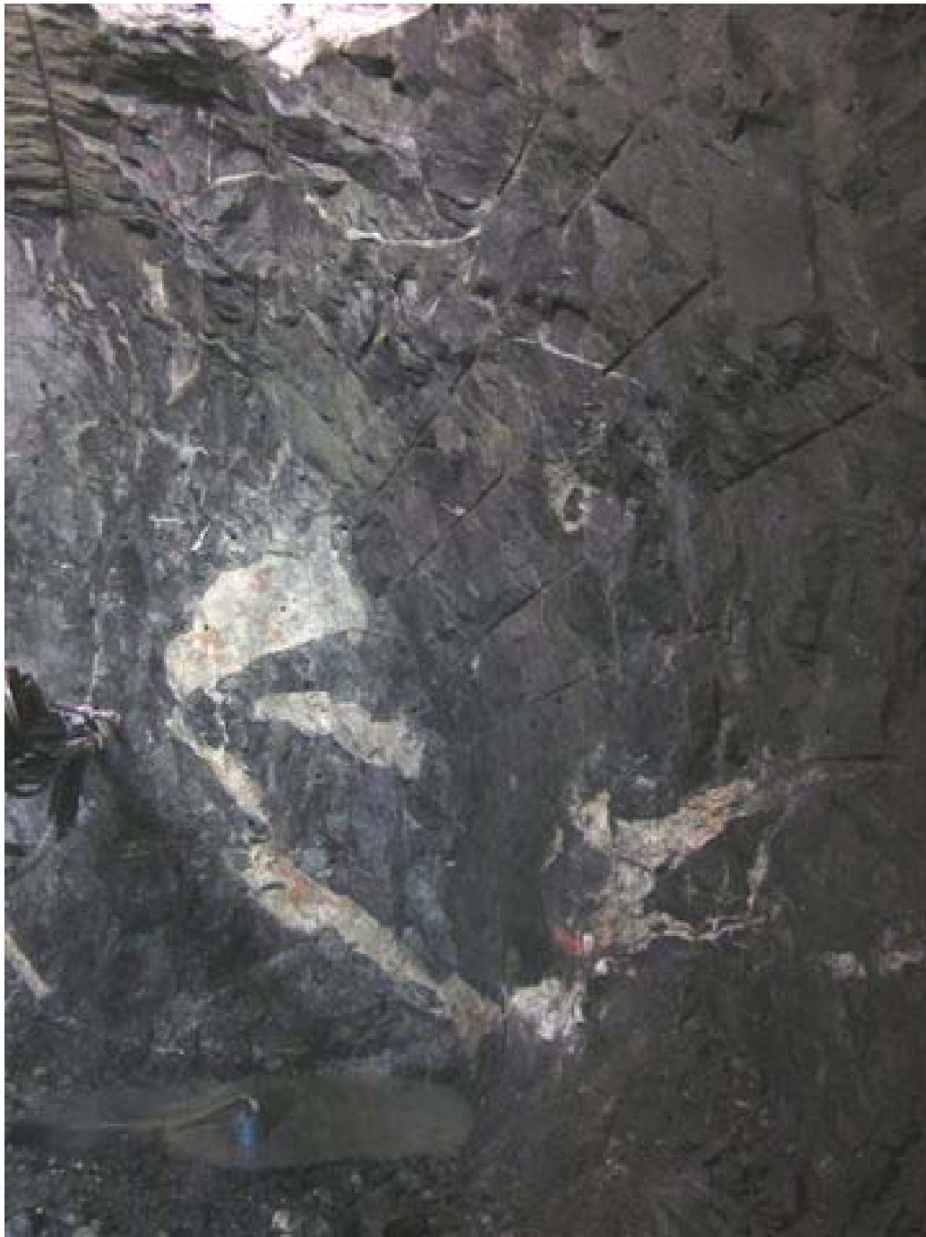
Høyre side 18.salve ca.profil 935-940, som vanlig ikke borpiper i veggen. Profilet ellers er ikke så galt.
