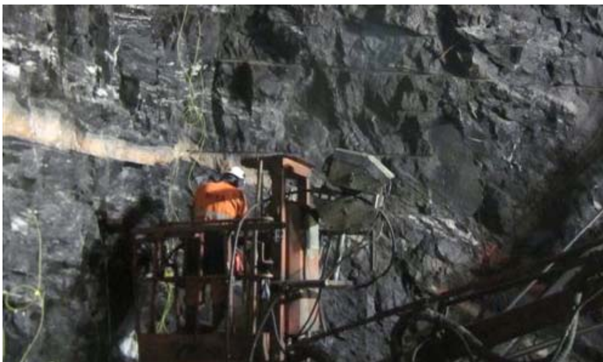
Figur 6 Ladekorga med slangetrekket (uttrekksmekanismen) i bakkant. Lading av siste salve med orange 17 mm rør i kontur.
