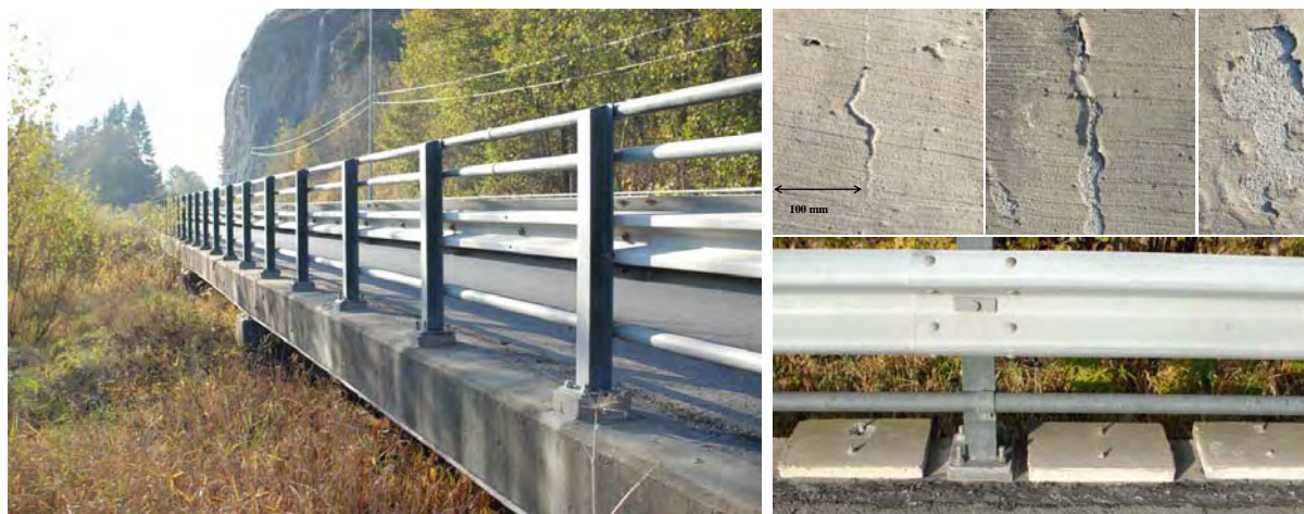
Figur 21 Foto fra Lundevann bru. Øverst til høyre: Elastisk sementbasert belegg, utvikling fra a) initielt riss til b) gradvis hefttap nært riss og c) massiv flassing. Nederst til høyre: Prøveplater boltet fast til kantbjelke
