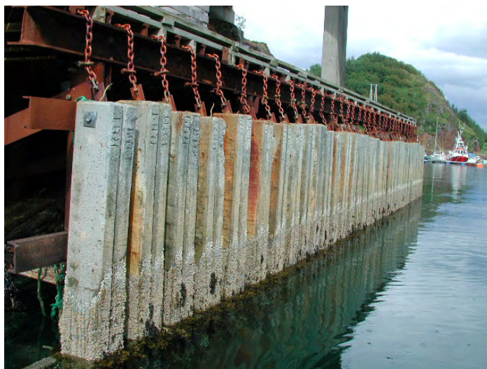
Figur 20 Armerte betongelementer i tidevannssonen i Sandnessjøen
