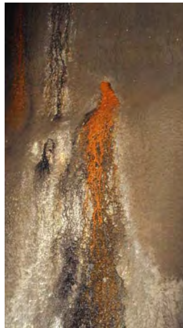
Figur 7 Testfeltet for sprøytebetong viste vekst av biofilm få veker etter etablering
