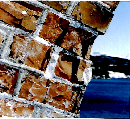
Typiske frostska- der på tegl på Skodjebrua.
