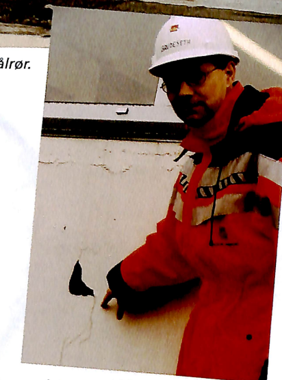
Vi har registrert sprekkene i bygningene, forteller Halgeir Brudeseth.
