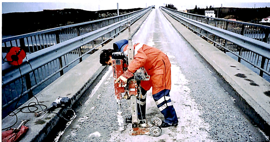
Tilstandsundersøkelser på Langøybrua på Averøya viste store skader som var med på å framskynde vedtak om riving og ombygging kostnadsregnet til ca. 40 mill. kroner. (Foto: Halgeir Brudeseth)
