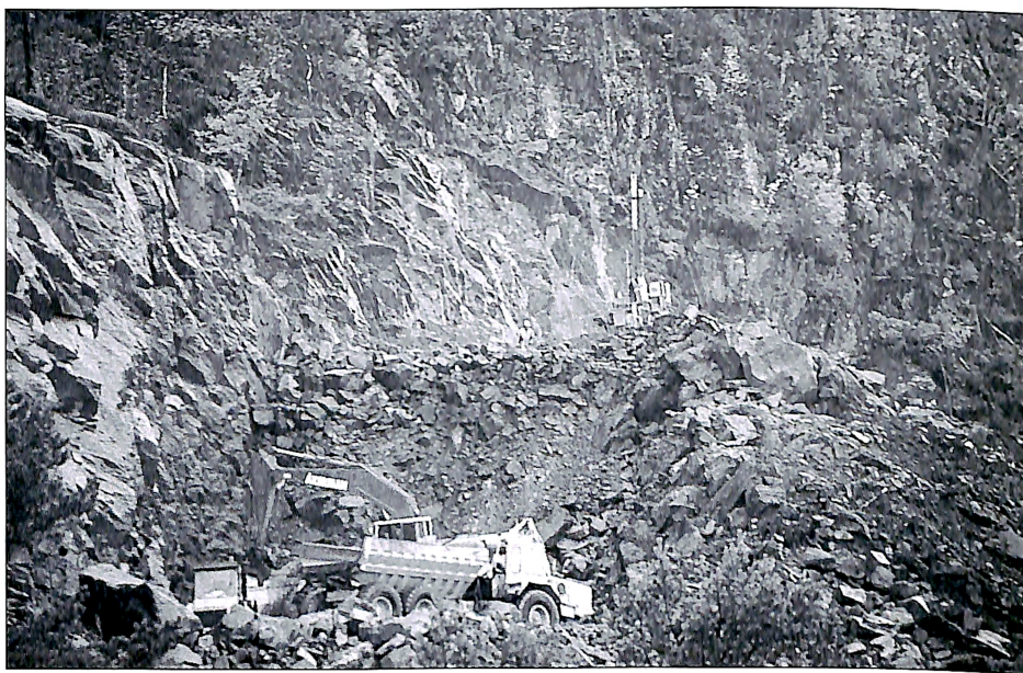
Arbeidet på pilarene til Smalsundbrua går framover som planlagt, samstundes som vegarbeidet over Ruøya nettopp har starta opp.
