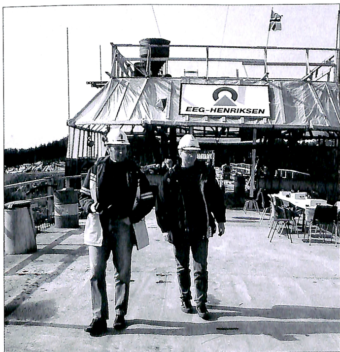
15. april, bare minutter etter at det siste betonglaget var lagt, kunne prosjektleder Oddbjørn Pladsen (t.v) og kontrollingeniør Jørn Arve Hasselø gå tørrskodd over Leirvikstraumen.
