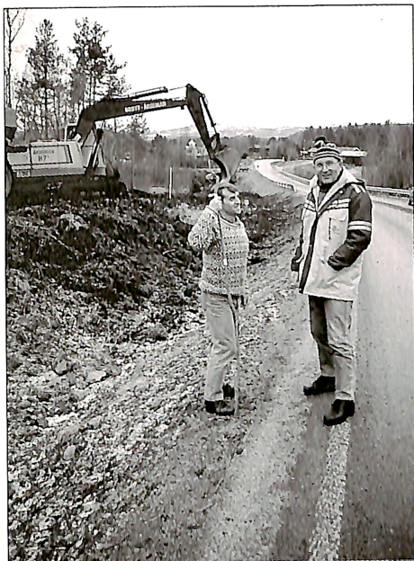
Anleggsleder Per Arne Gjerde og oppsynsmann Magne Nauste forteller at arbeidet går som planlagt.
