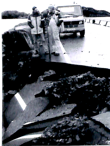
Skadane på Atlanterhavsvegen er kostnadsrekna til 1,2 millionar kroner. Vegmeister Harald Dragset og Magne Veiset likte ikkje skadane orkanen la etter seg. (Foto: Tidens Krav.)
