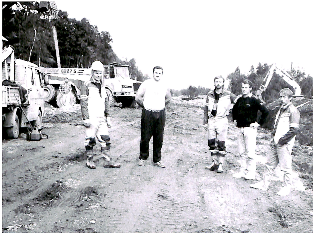
Vegvesenets folk gjør sin del av jobben på anlegget Remmem-Kjelbotn, som allertede er godt i gang. (Foto: Viktor Storsveen)
