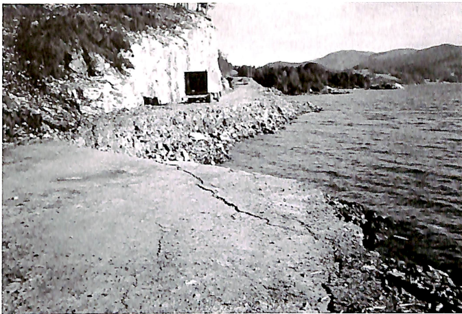
Rasstedet på Aspøya. Vi ser sprekkdannelse også på den gjenstående delen av veien. (Foto: Odd Williamsen)
