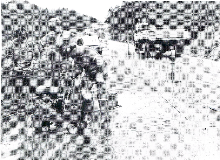
Vi ser her Roy Tore Sannes, Oddvin Jøsok og Kjell Steinar Sylte i ferd med å sage spor for detektorsløyfer i asfalten.
