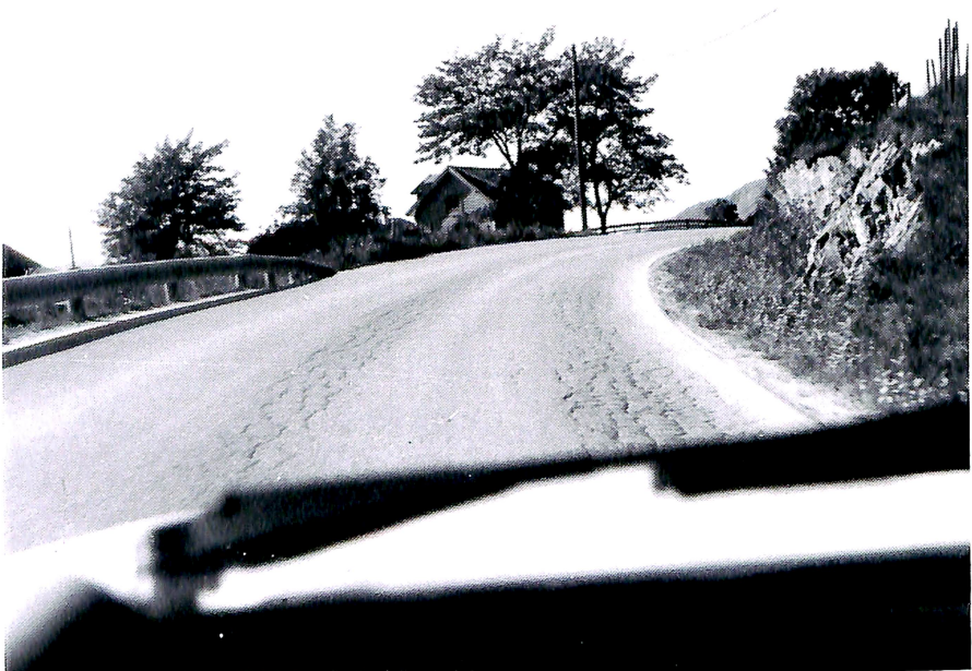
Skade på øvre vegside. Nedre side er skadefri.
