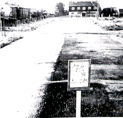
Isingssituasjon på forsøksveg 17. nov. 1974 kl. 12 30 i Trondheim. Høyre halvdel er bygget opp med grus under asfalten. Venstre veghalvdel er bygget opp med stein under asfalten.
