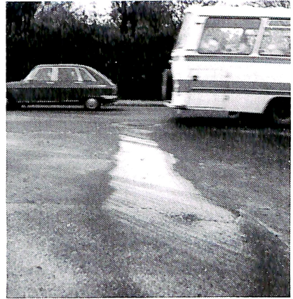
Ved gjenfylling av grøften benyttes ofte grovere materialer enn de som ble gravet ut. Dette gir økt ising på vegoverflaten fordi dekketemperaturen her blir lavere.
