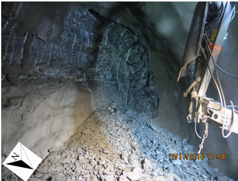
Figur 11 Bildet viser oppknust fjell i den krevende svakhetssonen. Piggmaskina kunne enkelt krafse ut løst fjell foran på stuff.
