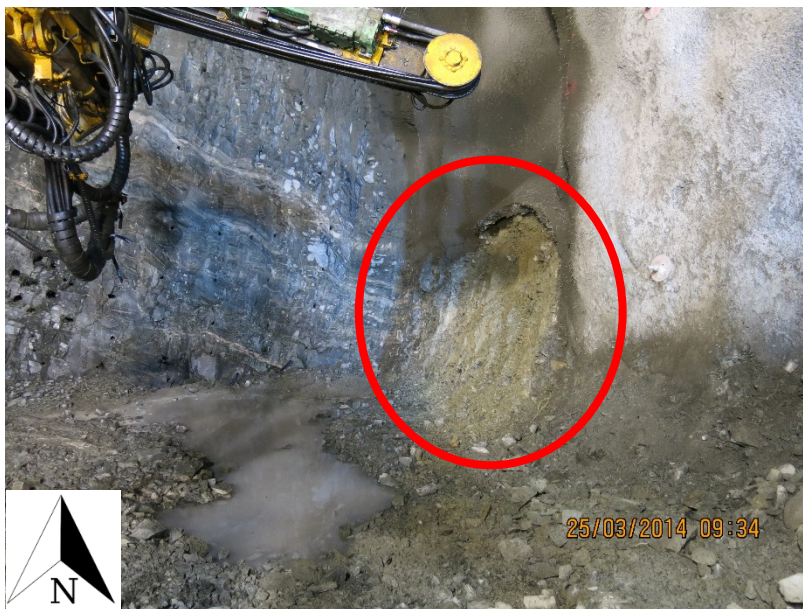
Figur 10 Et bilde fra drivingen som viser dårlig og forvitret fjell i pel.nr intervallet 33890-33945. Bildet er tatt fra søndre stuff.
