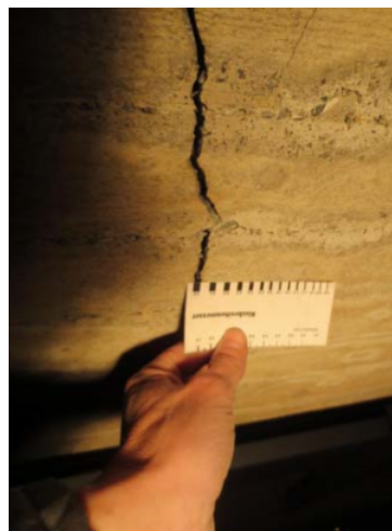
Figur 3.17: Riss i momentnullpunkt [16]
