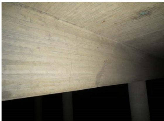
Figur 3.16: Riss i momentnullpunkt [16]
