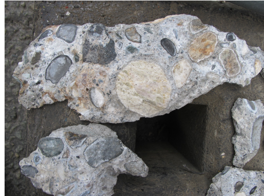
Figur 3.11: Ødelagte deler fra øvre del av dekket med klare tegn til alkalireaksjoner som hvite striper langs tilslagskornene [3]
