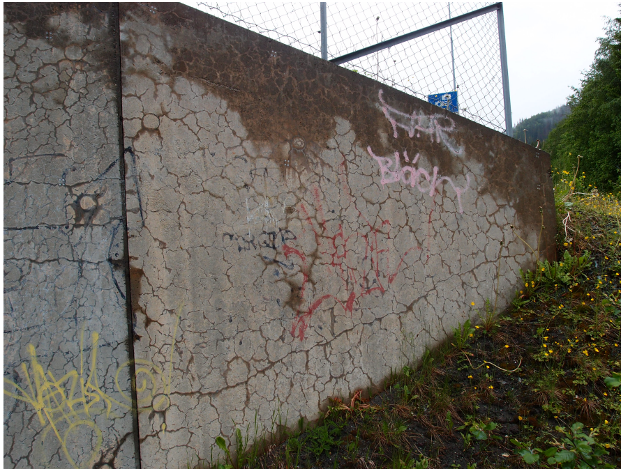
Figur 2.4: Krakeleringsriss fra alkalireaksjoner [eget bilde]
