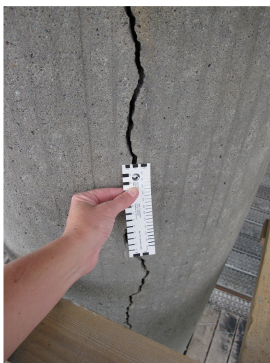
Figur 3.12: Søyle med rissvidde på 7 mm [4]
