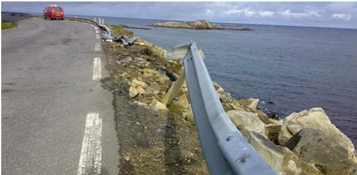
Figur 9-26 Skade på rekkverk (Foto: Statens vegvesen)
