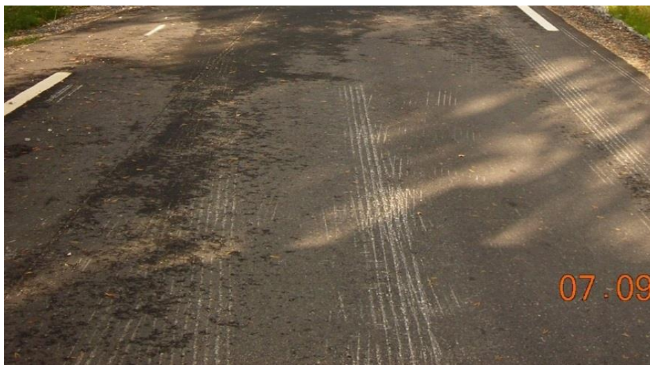
Figur 4-42 Skader på fast dekke (Foto: Statens vegvesen)
