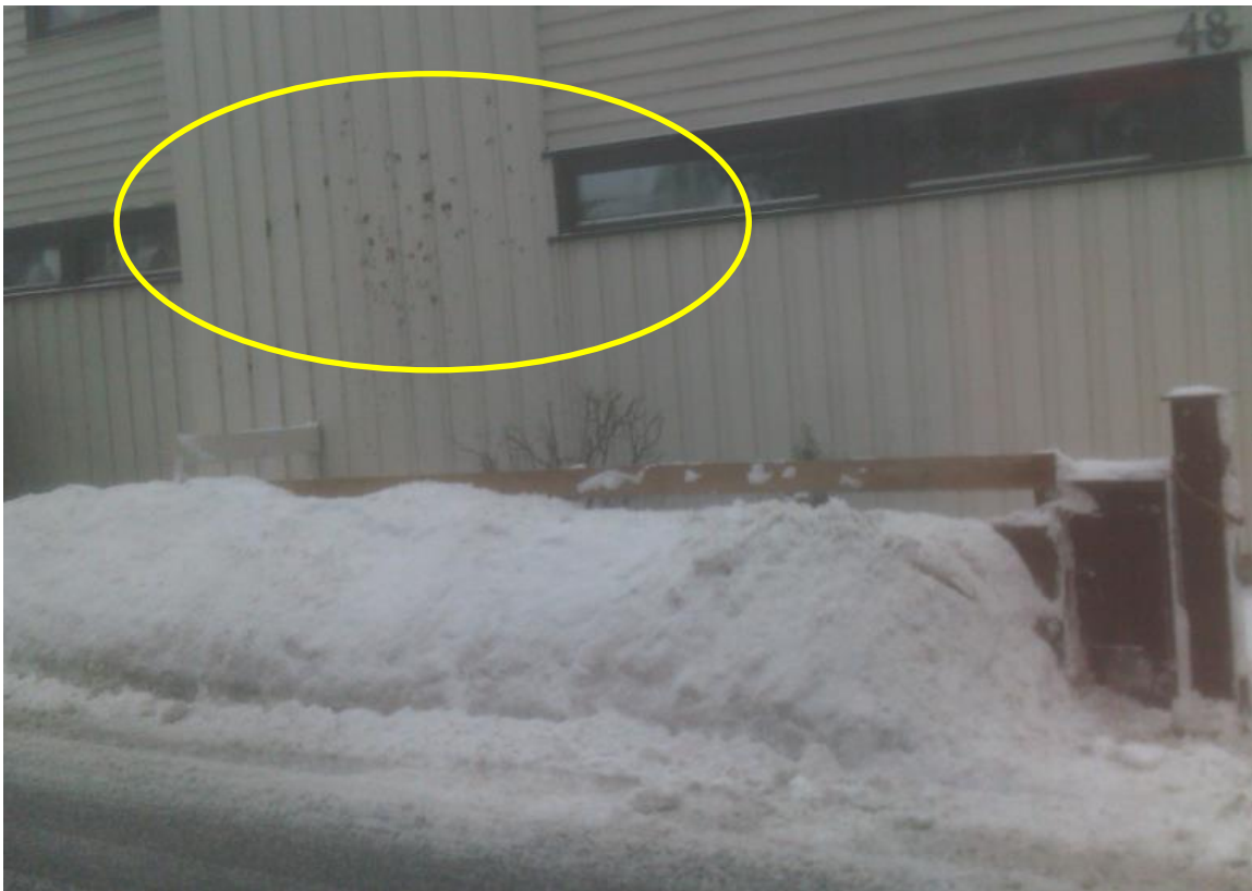
Figur 4-86 Uønsket sprut fra brøyting på fasade (Foto: Rudi Thomassen, Statens vegvesen)
