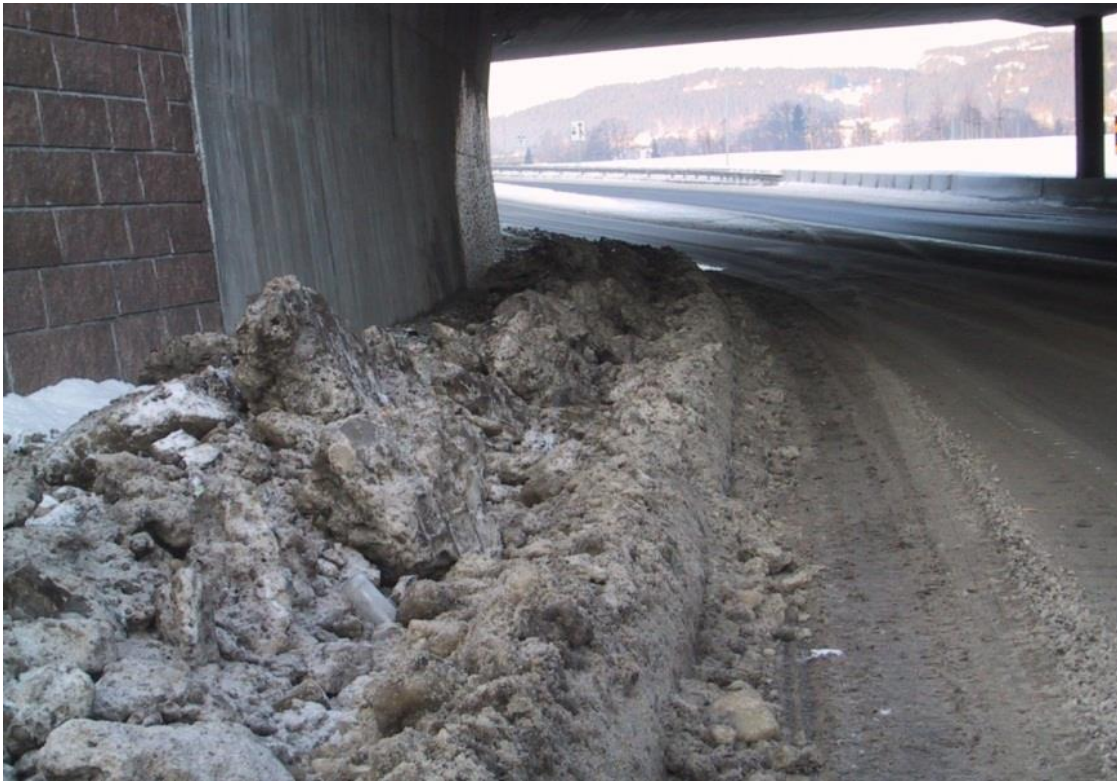
Figur 2-43 Ubrøytet fortau i undergang (Foto: Statens vegvesen)
