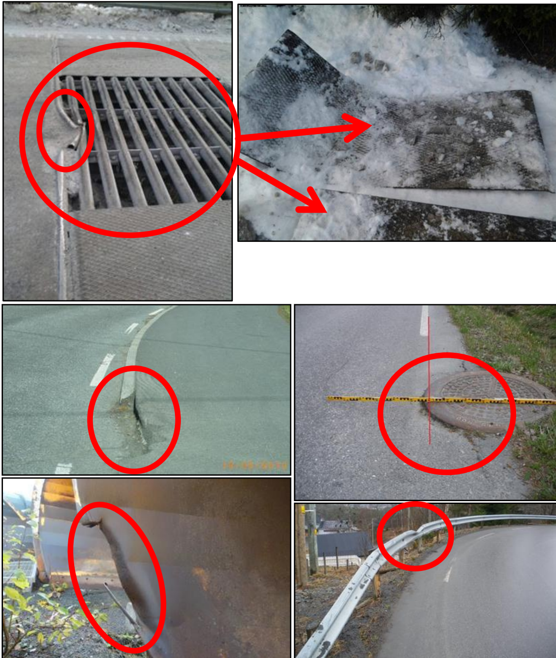
Figur 2-7 Øverst: hekking/skade på ferist fra brøyting/høvling (venstre) og løsrevet dekkplater til ferist (høyre). Midten: Skade på kantstein fra brøyting (venstre) og oppstikkende kum, fare for hekking av plog/skjær (høyre). Nederst: Skade på plog etter påkjørsel (venstre) og skadet rekkverk (høyre). (Foto: Tom Roar Sveen og Statens vegvesen).
