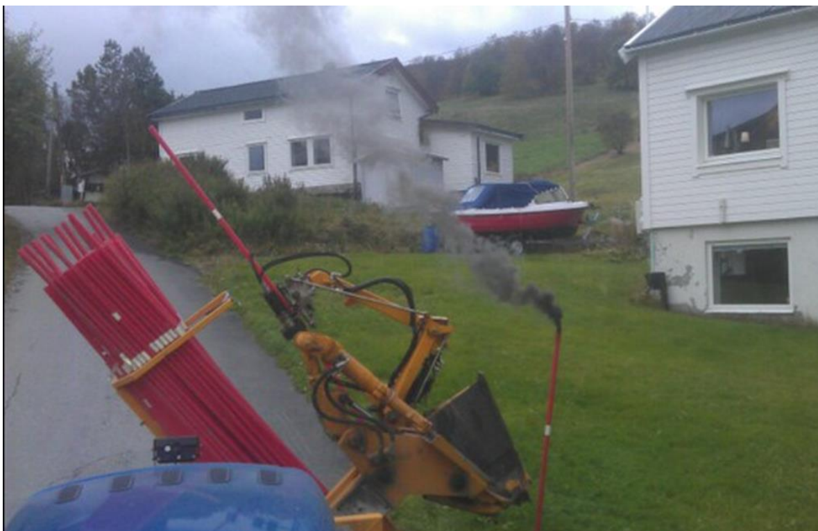
Figur 9-15 Stikksetter treffer høyspentkabel (Foto: Harstad Kommune)
