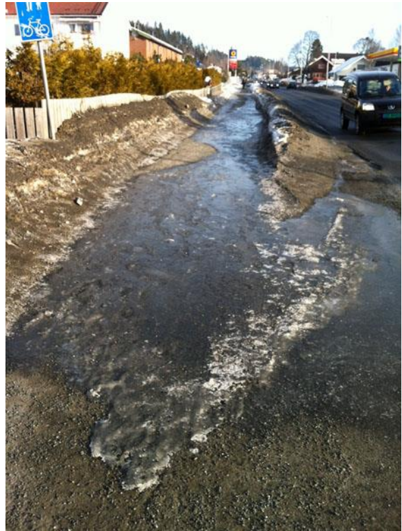
Figur 2-48 Tining og frysing på gs-veg (Begge foto: Arild Nærum)
