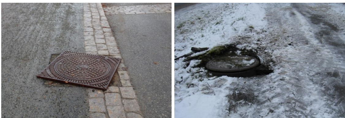
Figur 4-4 Kumlokkramme ute av stilling (t.v.), kum med overhøyde(t.h.). Fare for hekking. (Foto: Øystein Larsen)
