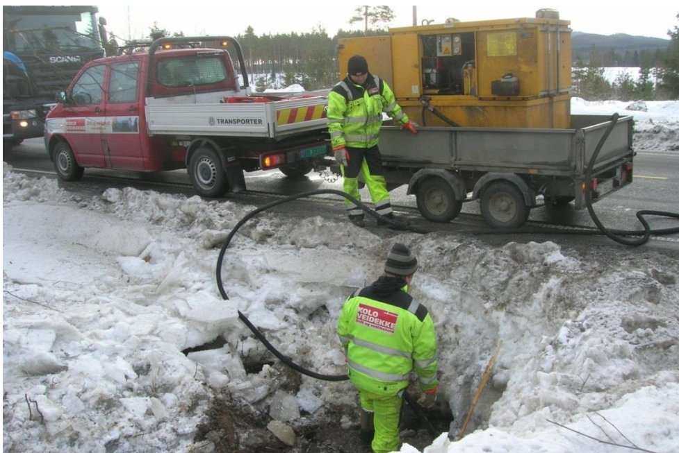
Figur 9-2 Tining av stikkrenne (Foto: Knut Magne Reitan)
