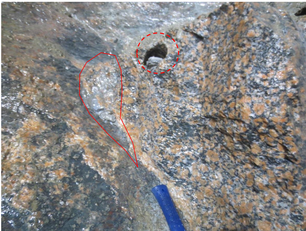
Foto 2: Fra pel 3.740. En skrå sleppe har blitt fylt opp med injeksjonsmasse, avmerket med rød mangelkant. Injeksjonshull oppe til høyre, avmerket med rød stiplet sirkel, er bare delvis fylt med injeksjonsmasse som ligger i bunnen av hullet. Bergarten er granittisk øyegneis.
