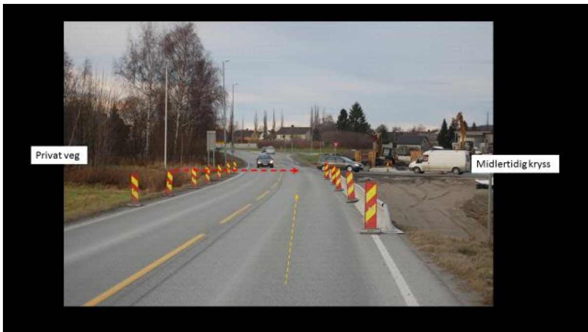
Figur 15: Bildet viser et anleggsområde som bl. a. omfatter etablering av et nytt kryss og en undergang for gs-trafikken under hovedvegen. I denne fasen var det etablert et midlertidig kryss like ovenfor den private vegen. En syklist (rød pil) ble påkjørt av en personbil (gul pil) da han skulle krysse over hovedvegen. Mange hindermarkeringer og anleggsmaskiner bidro sannsynligvis til at det var vanskelig å oppdage kryssende gs-trafikk, spesielt i mørket. Fartsgrensen var 50 km/t og det var ikke etablert noe midlertidig kryssingspunkt her.
