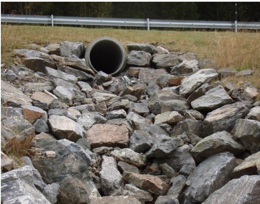
Figur 4.12: Eksempel på nedføringsrenne med stor, fritt utlagt stein. Rv. 70 Tingvoll. (Foto: H. Norem).
