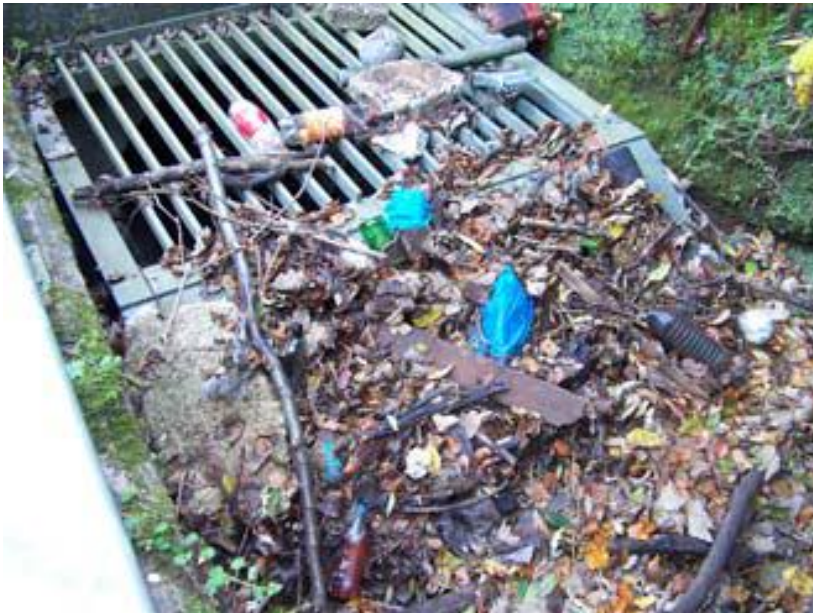
Figur 4.19: Eksempel på stikkrenne som holder på å tettes på grunn av søppel som har samlet seg rundt innløpet. (Wallerstein og Arthur 2012).
