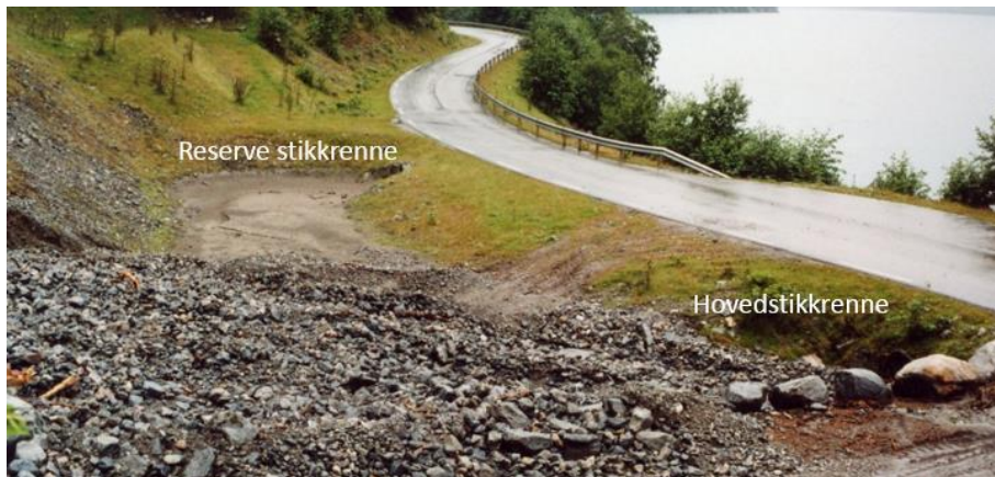
Figur 4.23: Foto av sedimenteringsbasseng og med ekstra stikkrenne i borte ende av bassenget, Fv. 192 Øvre Vike, Møre og Romsdal. (Foto. H. Norem).
