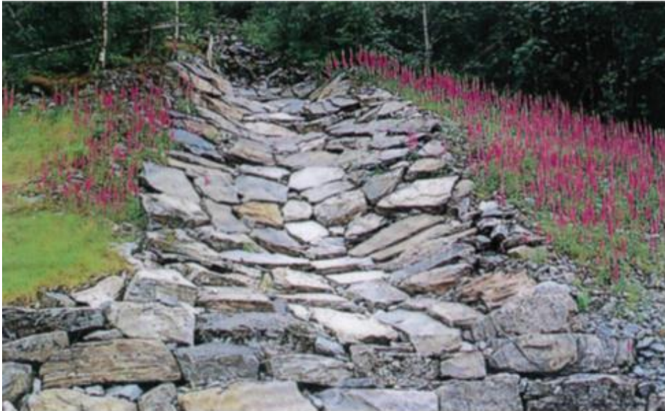
Figur 4.13: Eksempel på uheldig plastring. Plastringen gir et estetisk godt inntrykk, men blir for glatt, noe som fører til store vannhastigheter. Dessuten er steinene lagt med den største flaten opp, slik at faren for at plastringen kan få skade er stor.
