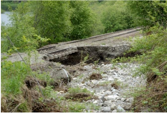
Figur 2.10: Undergraving av jernbanefylling på grunn av flom, Dovrebanen. (Foto: N. Svingheim).
