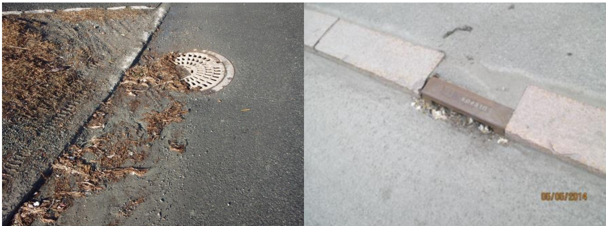
Figur 6.28: Eksempler på sirkulær slukrist og kjeftsluk. Slukrister plassert i vegbanen har tendens til å tettes igjen av løv og sedimenter. (Foto. H. Norem og G. Mosevoll).
