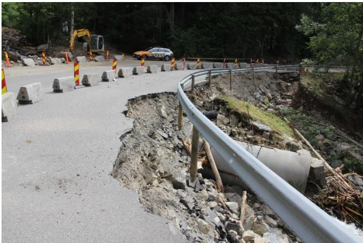
Figur 2.9: Skader på veg på grunn av skader ved utløp av stikkrenne og overløp av vann over vegen. Fv. 31 Luksefjellsvegen. (Foto: Tor Arvid Gundersen).
