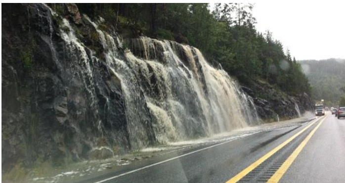
Figur 2.5: Oversvømmelse på veg som skyldes både dårlig kapasitet i sidegrøfter og i stikkrenner, Fv. 60 Olden. (Foto: K. Kjesbu).
