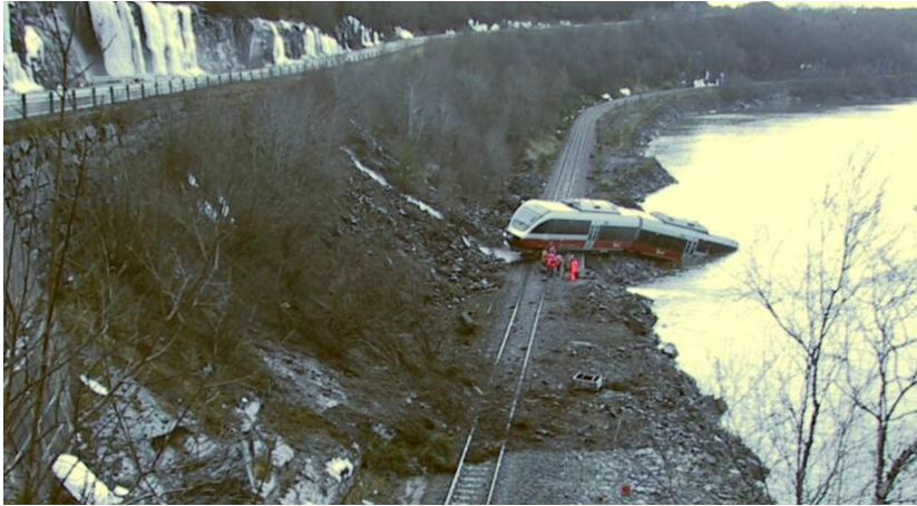
Figur 2.11: Mindre flomskred som er utløst ved utløpet av en stikkrenne for E6 og deretter forårsaket sperring av Nordlandsbanen og avsporing. (Foto: Bane NOR).
