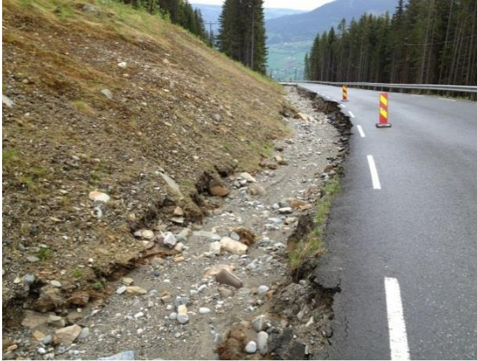
Figur 2.8: Skader på grøft og vegskråning etter flom Veg til Kvitfjell. (Foto: S. Myrabø).
