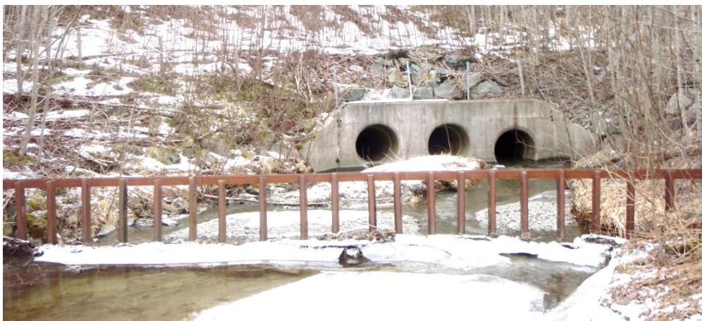
Figur 4.20: Eksempel på rist i fremkant av stikkrenne for å fange opp sedimenter, greiner og søppel ved Rødde langs Dovrebanen. Merk at det venstre røret ligger noe høyere enn det høyre. Det er derved tørt og fritt for is om vinteren. (Foto: H. Norem).
