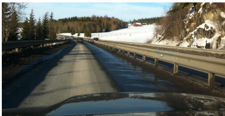
Figur 6.6: Smeltevann fra brøytekant mot rekkverk som har rent ut i kjørebanen, E6 Skaberud. (Foto: J. Nøkleholm).
