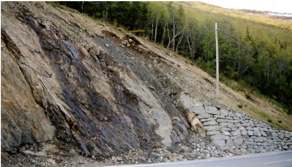
Figur 4.33: Bergskjæring med ustabil, vannførende løsmassedekke. E39 ved Hemnkjølen (Foto: H. Norem).
