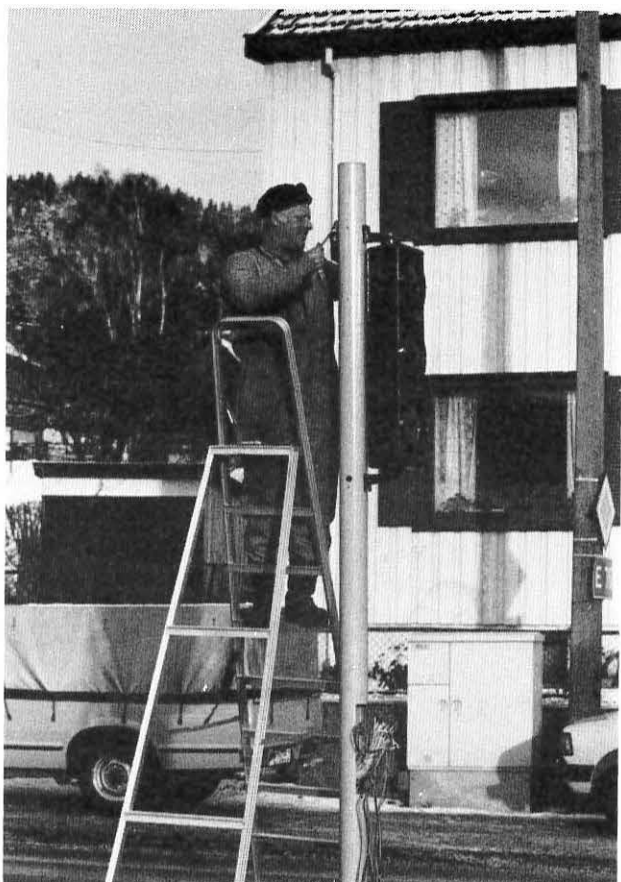
I Drammen er det 43 lyanlegg som skal vedlikeholdes.
