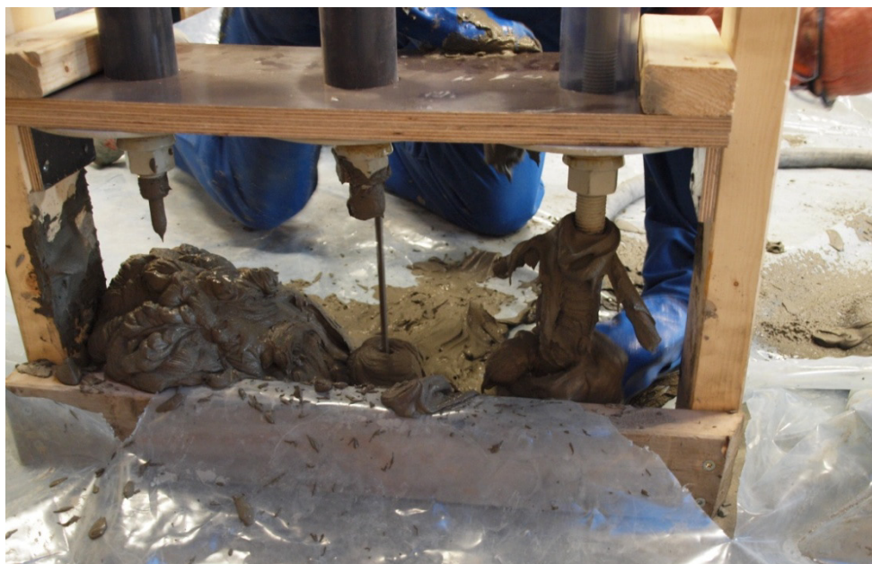
Foto 5 Mørtelen rant ut fra alle 5 m lange vertikale rør med rørbolter (her før gysing av siste rør)
