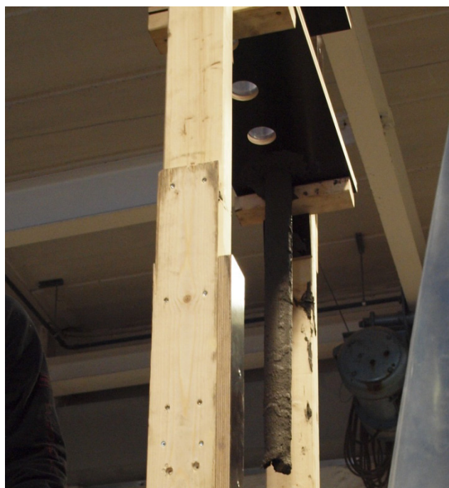
Foto 10 Kamstål og mørtel siger ut igjen etter montering
