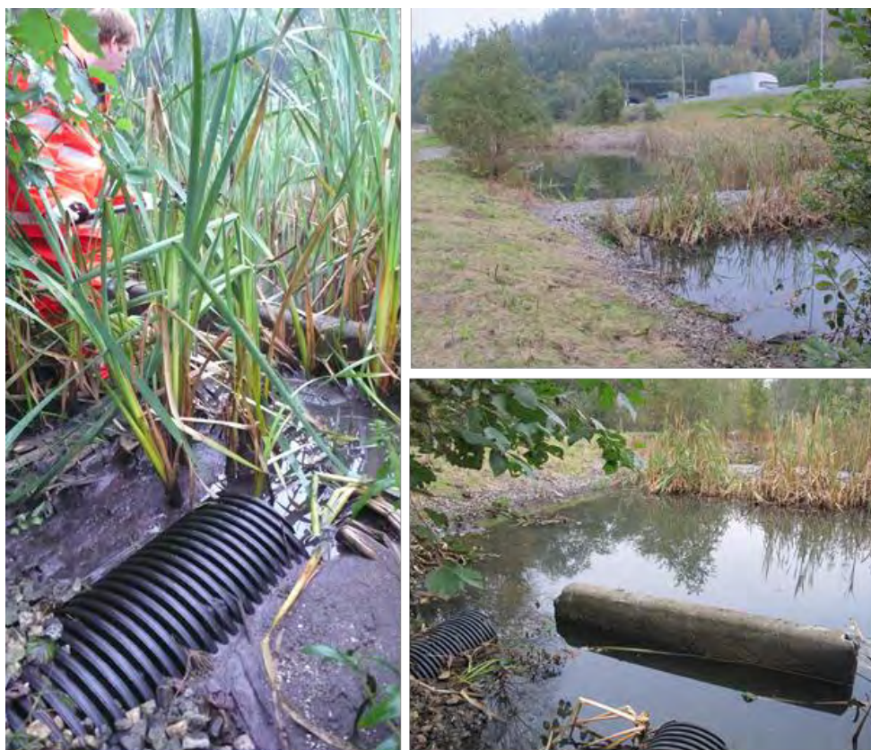
Figur 2. Bildene viser forholdene før og etter tømming av sediment i forsedimenteringskammeret. Bildet til venstre viser det ene innløpsrøret som er betydelig tildekket med sediment. Sedimentet har trolig fungert som en barriere og har hindret effektiv drenering av forurenset vaske- og avrenningsvann. Bildet oppe til høyre viser forsedimenteringskammer samt hovedbasseng. En betydelig mengde vegetasjon ble også fjernet i forbindelse med tømmingen av sediment. (Foto: Kjersti Wike Kronvall).
