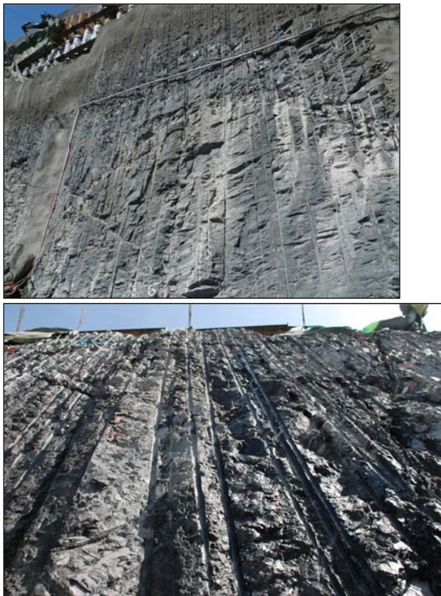
Figur 39 Slik kan det også gjøres! Resulterende kontur i 20 m høye skjæringsvegger presplittet med detonerende lunte i Oslofeltets i utgangspunktet lite konturvennlige skifrige bergarter
