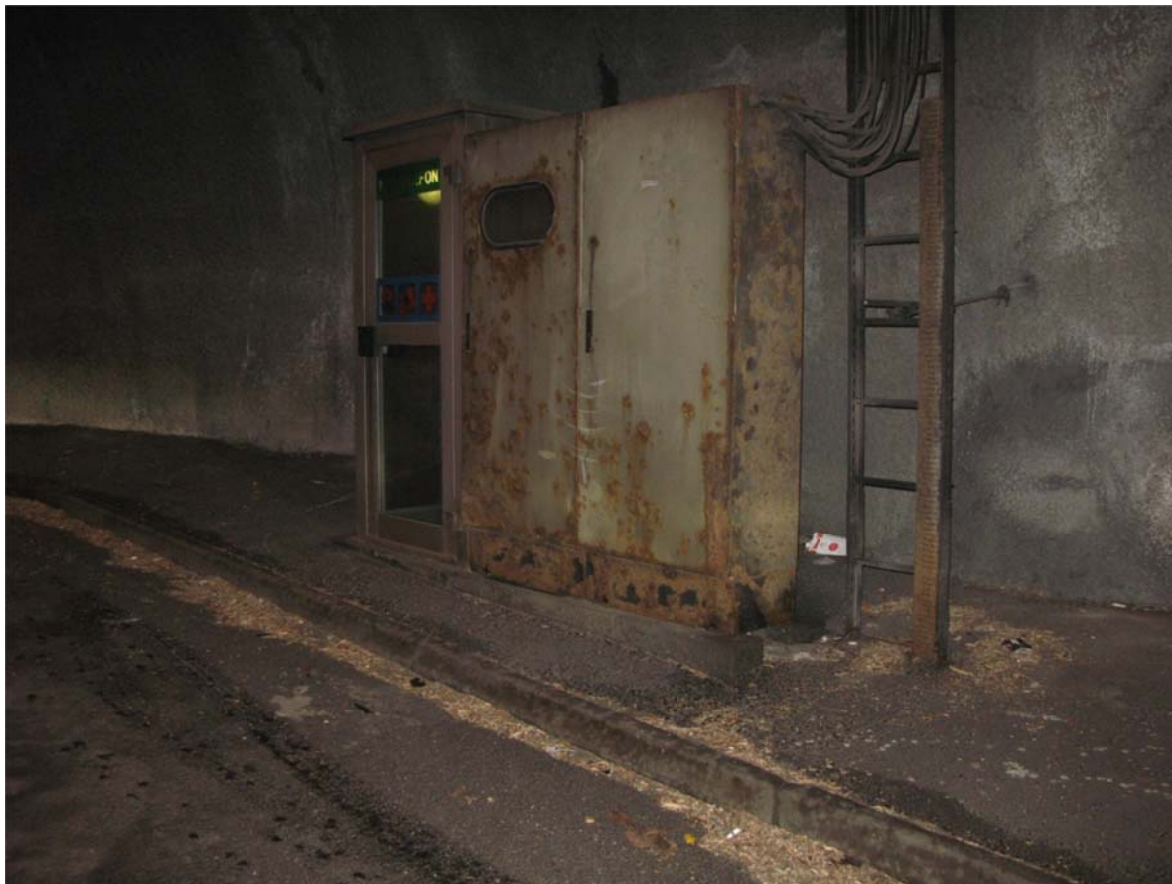
Figur 28 Bildet viser at det kan være utfordrende å finne riktig materiale i tunneler. (Foto: Jan-M. Østvik, Statens vegvesen)
