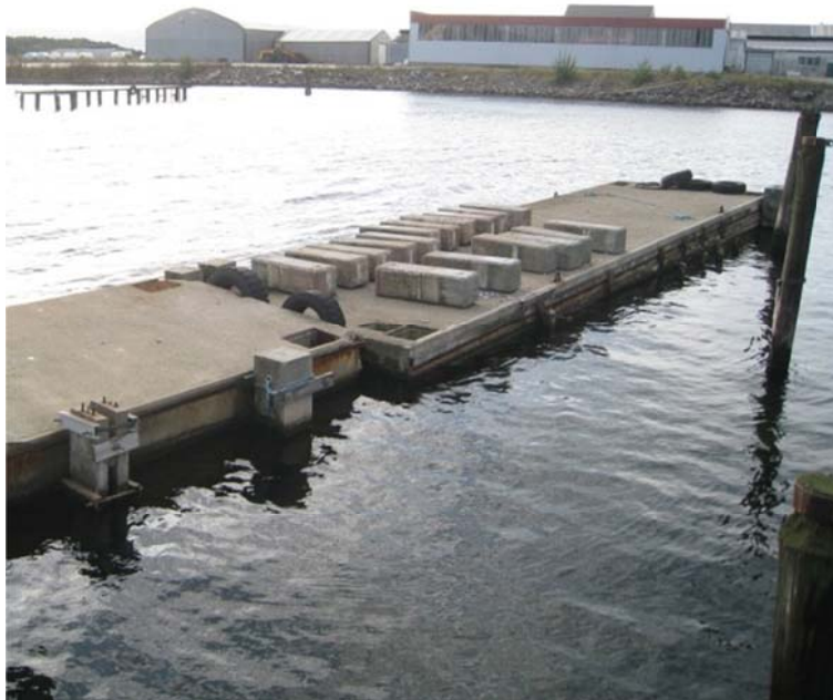
Figur 25 Armerte betongelementer i tatt opp for uttak av kloridprøver, feltstasjonen i Kristiansand.
