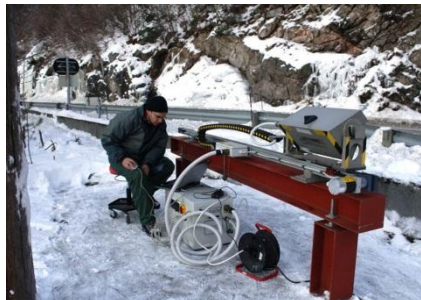
Radaren som måler skredbevegelser ved Rv. 70 forbi Oppdølsstranda (foto. Åknes/Tafjord Beredskap IKS)
