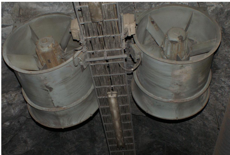
FIGUR 14 SLITTE VIFTER I PORSGRUNNTUNNELEN PÅ FV 356 (FOTO: DAG ØDEGÅRD, STATENS VEGVESEN)
