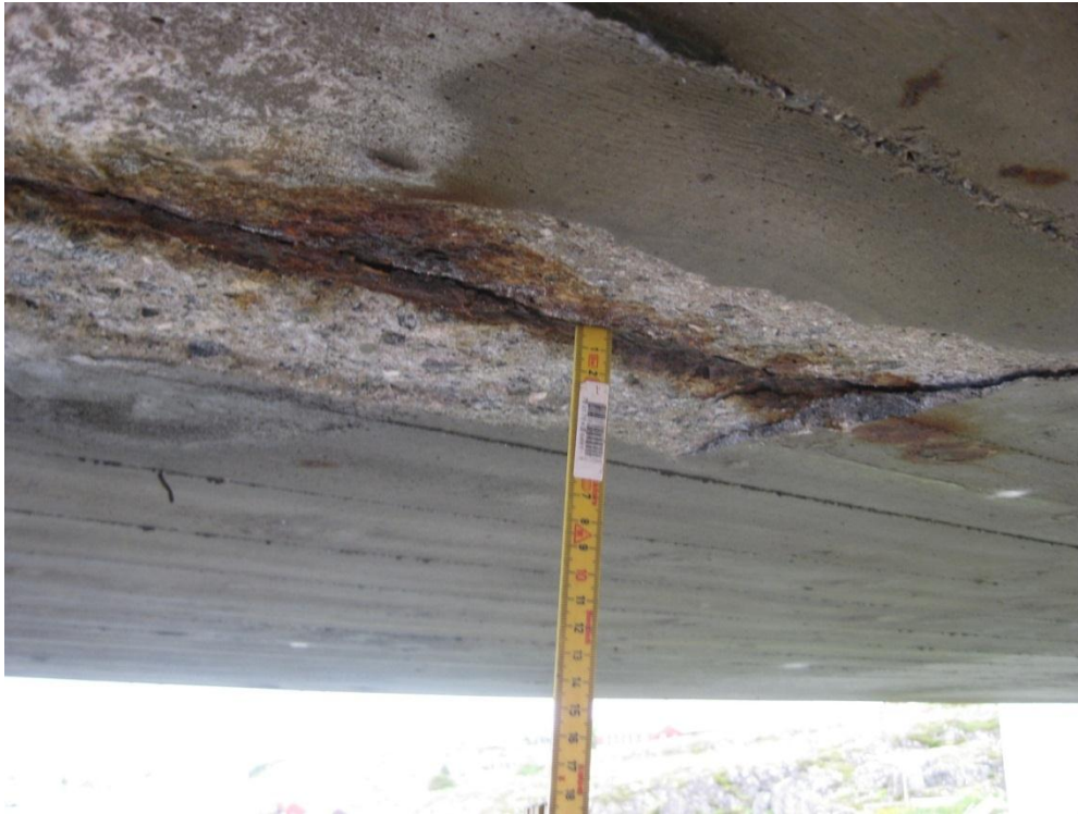
FIGUR 22 KORRODERT ARMERING PÅ MAUSUND BRU PÅ FV 436
