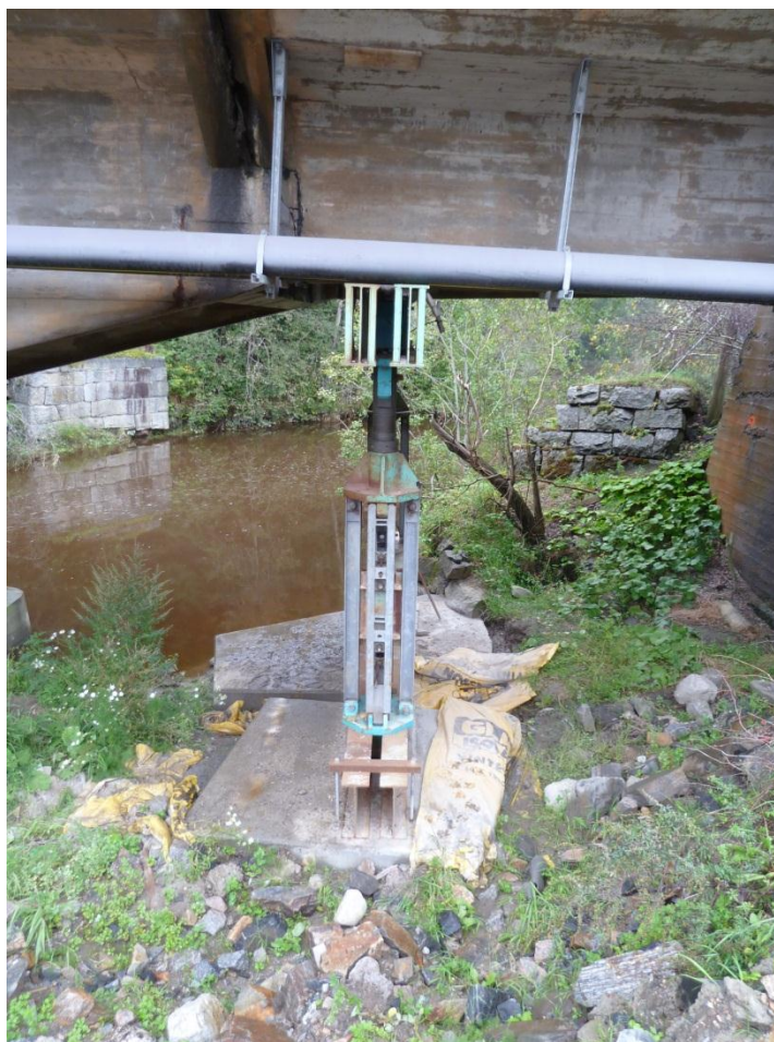
FIGUR 9 SKJELLFOSS BRU PÅ FV 120 – UNDERSTØTTELSE GRUNNET SKADE
