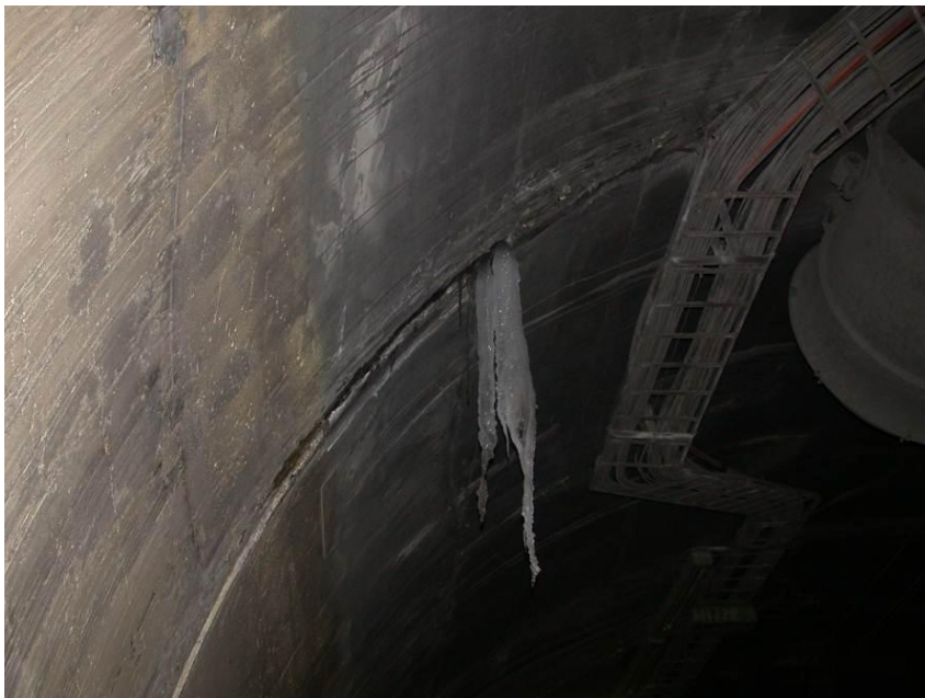
FIGUR 3 EKSEMPEL PÅ DÅRLIG VANN OG FROSTSIKRING I TUNNEL
