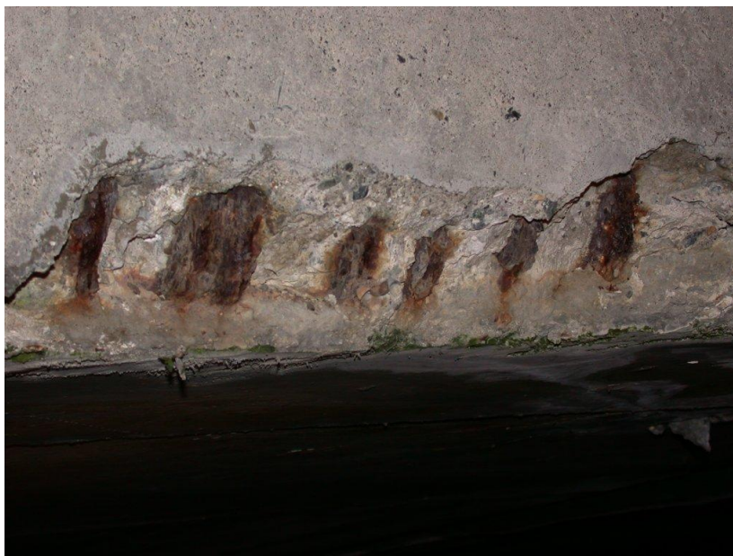
FIGUR 1 EKSEMPEL PÅ KORRODERT ARMERING PÅ BETONGBRU (FOTO: JAN MAGNUS ØSTVIK, STATENS VEGVESEN)
