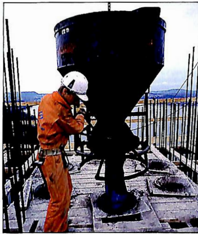
Bjørn Morten Bruvik styrer betongtobben på plass på taket, 4 meter over selve støpeplattformen.
