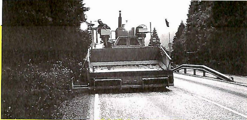
Sideutleggaren i aksjon med legging av fresemasse i grøfta langs E68 i Haldal.
