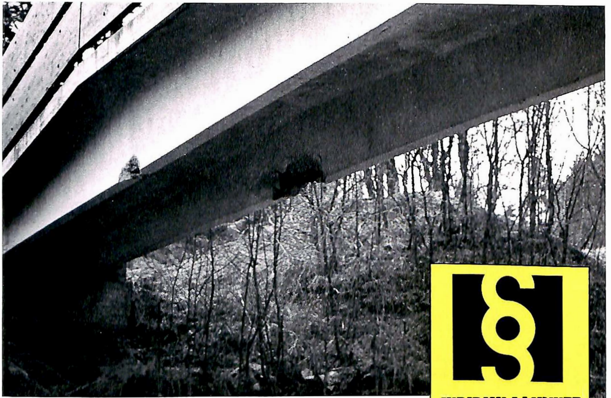
Mange gangbruer i Hordaland er skadde — meir og mindre alvorleg. Her er ei bru over Rv. 554 mellom Rådal og Flesland. Foto: E. Rønvik.
