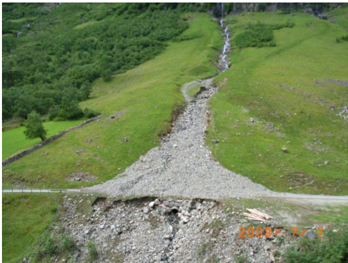
Figur 6.32. Foto av erosjon i flombekk og som har ført steinmasser fram til vegen, sperret stikkrenne og ført til store erosjonsskader. Fv. 241 Gudvangen-Bakka, Sogn og Fjordane. (Foto: S. H. Frækaland)
