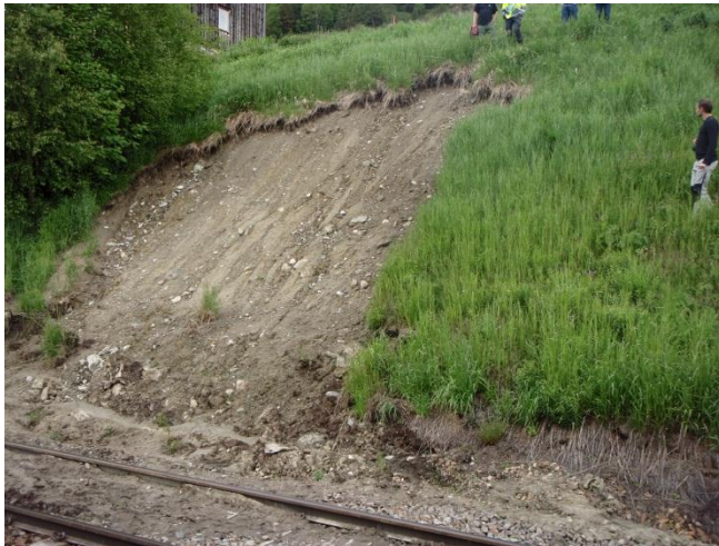
Figur 2.2. Eksempel på overflateskred, Dombås, Dovrebanen (Foto Harald Norem)
