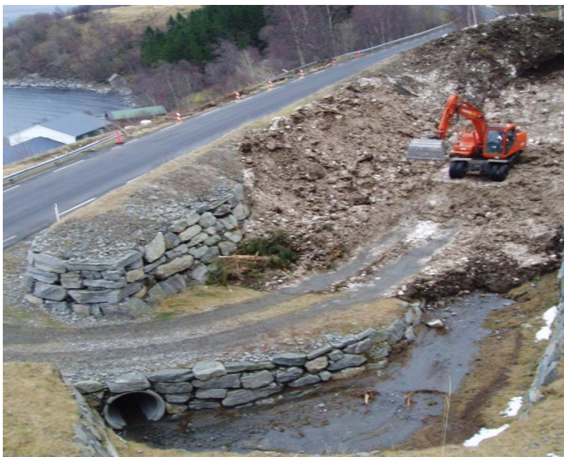
Figur 6.31. Foto av fangvoll og sedimentasjonsbasseng for sikring mot snøskred, sørpeskred og flomskred. Fotoet viser adkomstveg og innløpet for dreneringen. Denne ligger beskyttet og er åpen selv etter at det store skredet har fylt igjen sedimentasjonsbassenget. Alternativ drensveg er i dette tilfellet lagt mellom vollen og vegen. E39 Festøy-Ørsta. (Foto: H. Norem)
