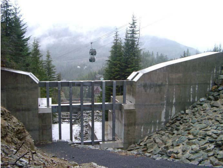
Figur 6.24. Eksempel på åpen kontrolldam med stålbjelker for å retardere og holde igjen skredmassene. Dammen er dimensjonert for et skredvolum på ca 30 000 m 3 . Whistler Mountain, Canada. Unzen, http://step.ipgp.fr/images/e/e3/09_02_Debris_Flow_Mitigation.pdf
