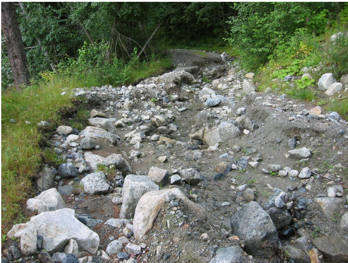
Figur 4.8 Eksempel på ukontrollert drenering langs en skogsbilvei i Gol 2007 (Foto NGI)
