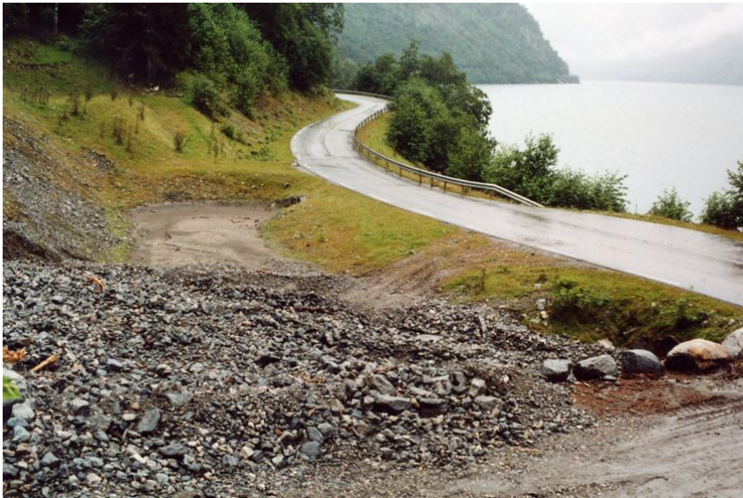
Figur 6.3. Foto av sedimentasjonsbasseng hvor vegen representerer fangvollen og hvor det er bygget alternativ drensveg 30 m til side for hovedløpet. (Foto: Harald Norem)
