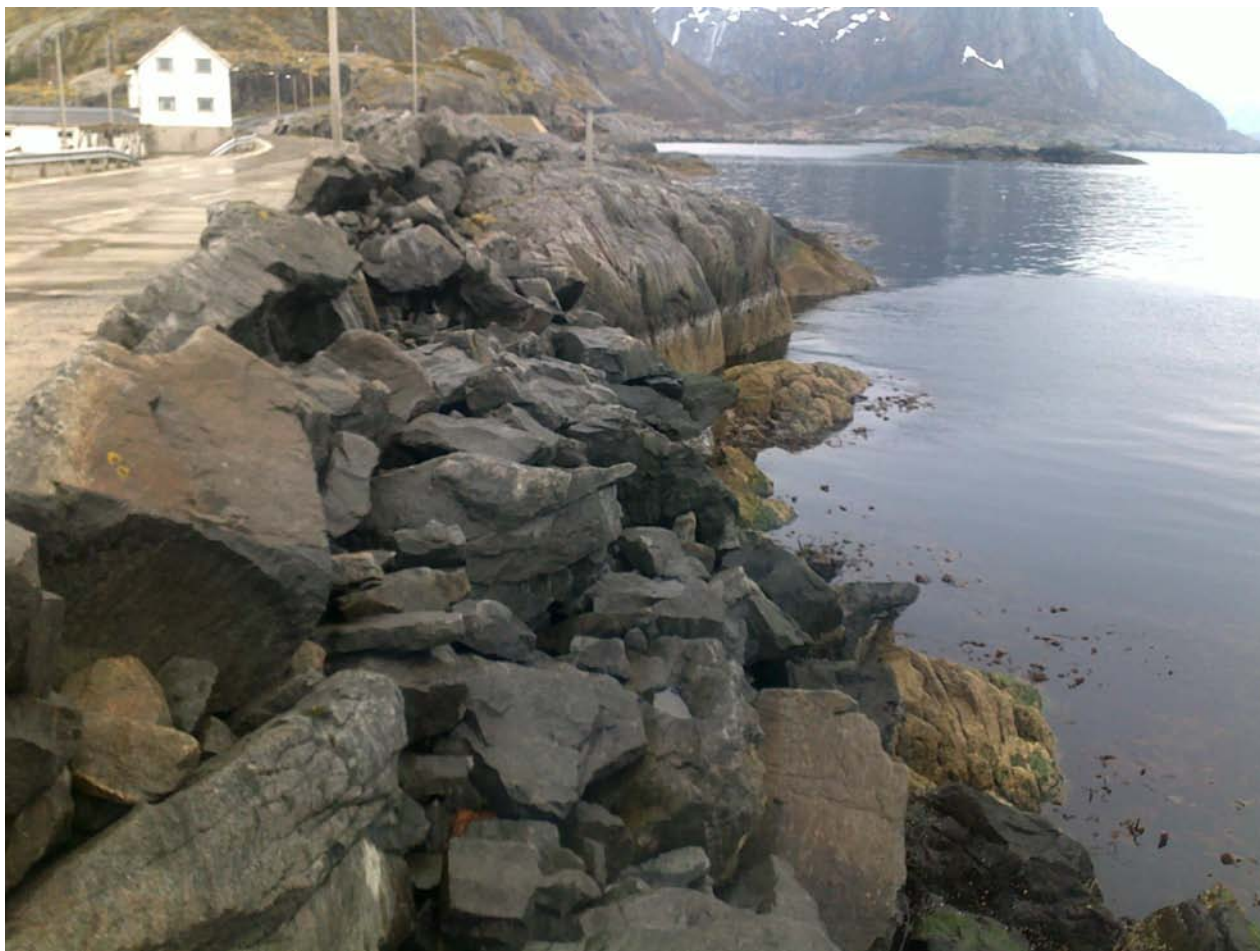
Figur 2 Bilde tatt fra Rundkulten i retning nordover. Vegen er her markert som en smal 1-felts veg med en parkeringslomme på østsiden (nærmest kamera). Fyllingen mellom ”fastlandet” og Hamnøya går delvis over fast fjell på holmer og skjær, men her består de nærmeste 10 – 15 m av steinfylling. Vegbanen er støpt betongdekke. Det er satt opp et ordnet brystvern av steinblokker i ca 1.0 m høyde, men på utsiden av brystvernet er fyllingen i til dels svært dårlig forfatning. Det er tynn overdekning til underliggende kjernemasse, de store dekkblokkene mangler (som følge av bølgeangrep eller fordi de ikke har vært lagt ut), fronten er delvis kritisk steil og mye av dekklaget består av mindre stein i størrelse 100 – 200 kg på et sted der en vil forvente dekkblokker i størrelse over 5.0 tonn.
