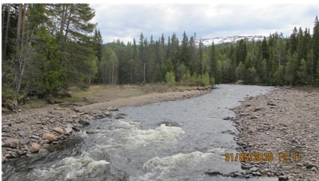
Bilde 20. Elveløpet på oppstrøms side av Tanselv bru på Fv.H-037 (Foto: B. Dolva).
