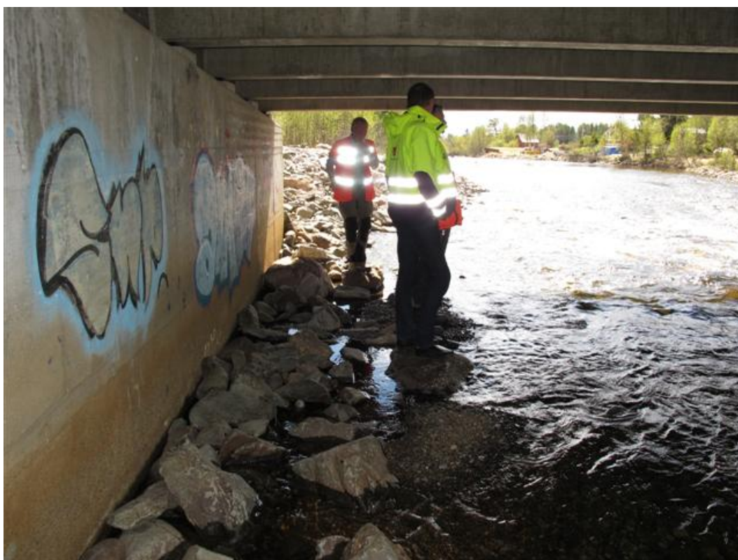
Bilde 27. Landkaret (i retning mot Krossen (øst) med foreløpig utbedring (innpumpet betong) sett fra oppstrøms side av Bitu bru på Fv.H-362 (Foto: H. O. Hagen 31/5-2010).
