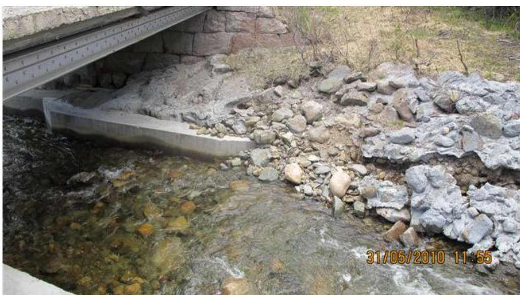
Bilde 14. Stavså bru på Fv.H-037 – detalj fra nordsiden av elvebredden på oppstrøms side som viser pågående erosjon (Foto: B. Dolva).
