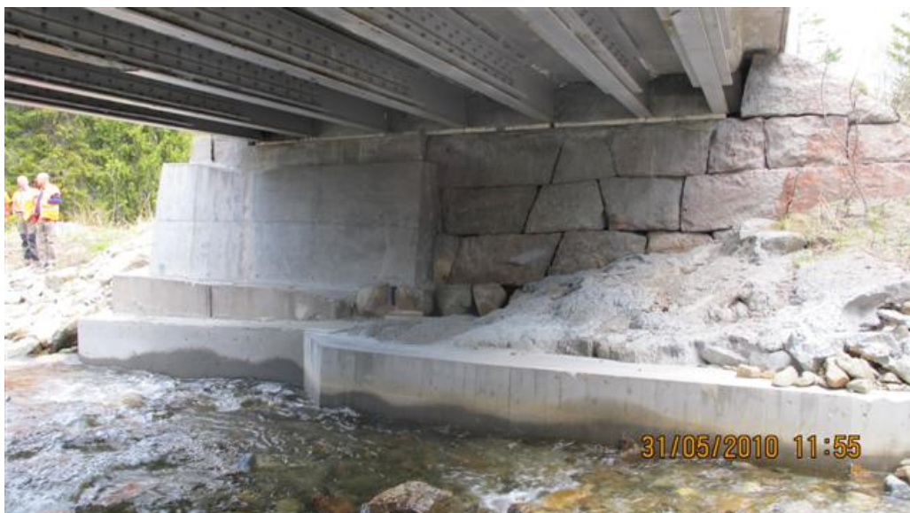
Bilde 12. Stavså bru på Fv.H-037 – detalj fra landkaret på nordsiden, med 3 generasjoner utbedringer (Foto: B. Dolva).
