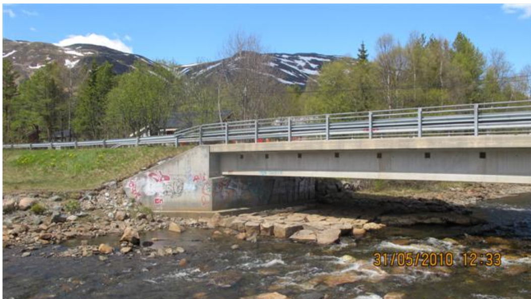
Bilde 24. Bitu bru på Fv.H-362 – landkar i retning Raulandsgrend (mot vest) sett fra nedstrøms side med deler av opprinnelig erosjonssikring intakt (Foto: B. Dolva).
