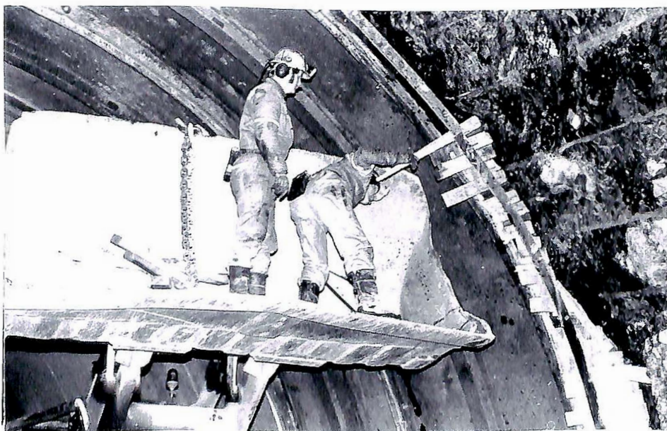
Tunnelarbeid blir det mellom anna på to av innfartsårene til Bergen, med Troldhaugtunnelen og tunnel mellom Eidsvåg og Ervik. (Foto: V. Arnesen)
