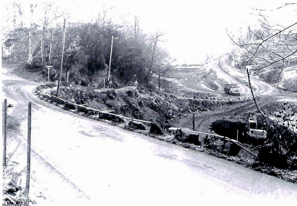
Biletet syner litt av anleggsområdet på Hop. Vegen foran på biletet er Troidhaugvegen. (Foto: V. Arriksen):
