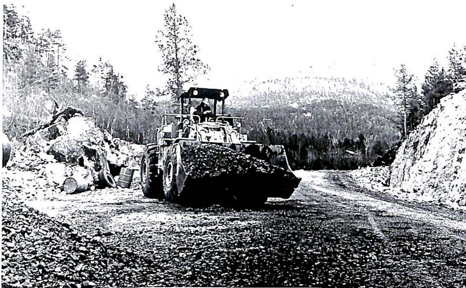
Frå arbeidet på den nye vegen forbi Statheimskleivene som blir opna i år.
