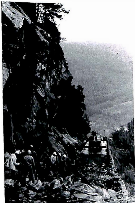
Om lag 100 meter oppe fjellsida losna raset som tok med seg 30 meter av vegbana mellom Kvanndal og Granvin. (Foto: V. A.)
