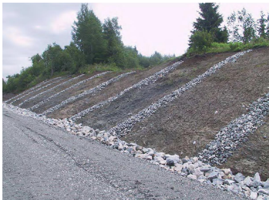
Figur 245.4 Skråningsdren vinkelrett på vegggrøft (Rv 120, Nannestad. Foto: Arvid Sagbakken)
