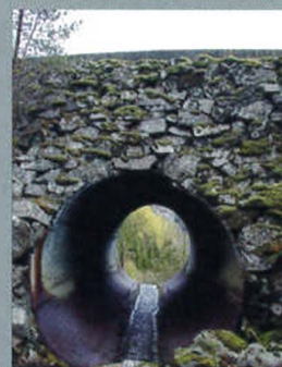
Røyr med rustskader.
