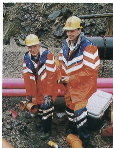
Edvin Skjøllingstad (t.v.) og Lars Øyvind Brekke i arbeid med vatn- og kloakkøyr. Legging av kablar og røyr er ein tung del av arbeidet i Skåredalen, som snart blir ein ny bydel i Haugesund.
