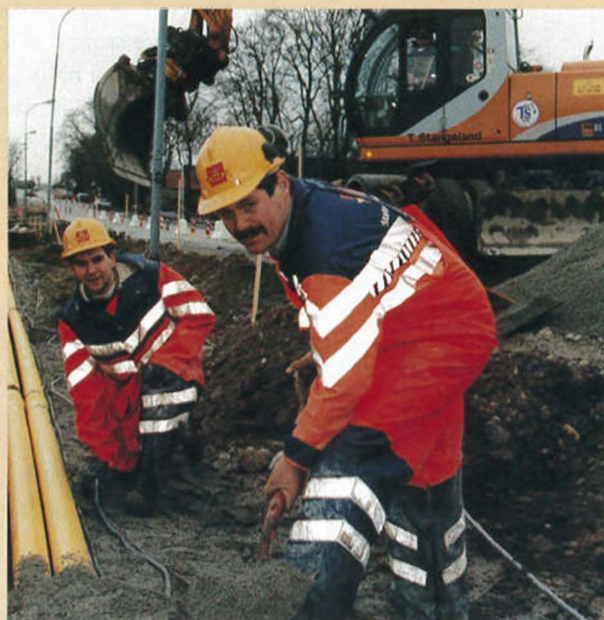
I gang- og sykkelvegtraseen blir det lagt kablar for Telenor og vass- og kloakkrøyr for kommunen. Her er Svein M. Nødland og Marton Tunheim i arbeid med å dekkja til ein kabel med fin sand.
