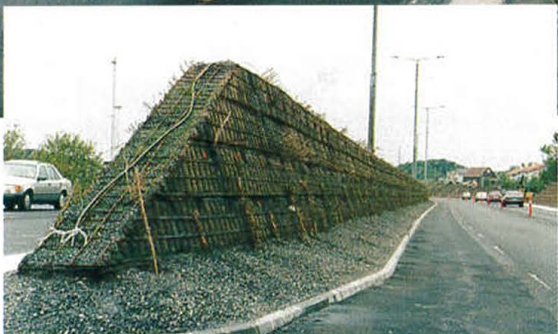
Mot boligområda ved Godeset er det bygt støyvoll både langs vegkanten og i midtrabatten mellom sør- og nordgåande kjørefelt. Terramur heiter konstruksjonen, som er ei blanding av grus og jord med armeringsmatte utanpå. Langs muren er det planta «klatrevækster» som etter ei tid skal dekkja heile støyvollen.
