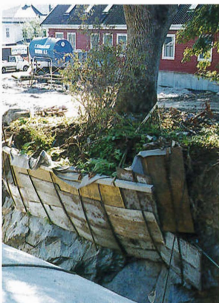
Et tre langs tunneltraseen på Rv.1 i Hillevåg stod så nær byggegropa at deler av massene under treet forsvant under sprengingen. Treet tok vi vare på med forskaling, torvstrø og vanning.
