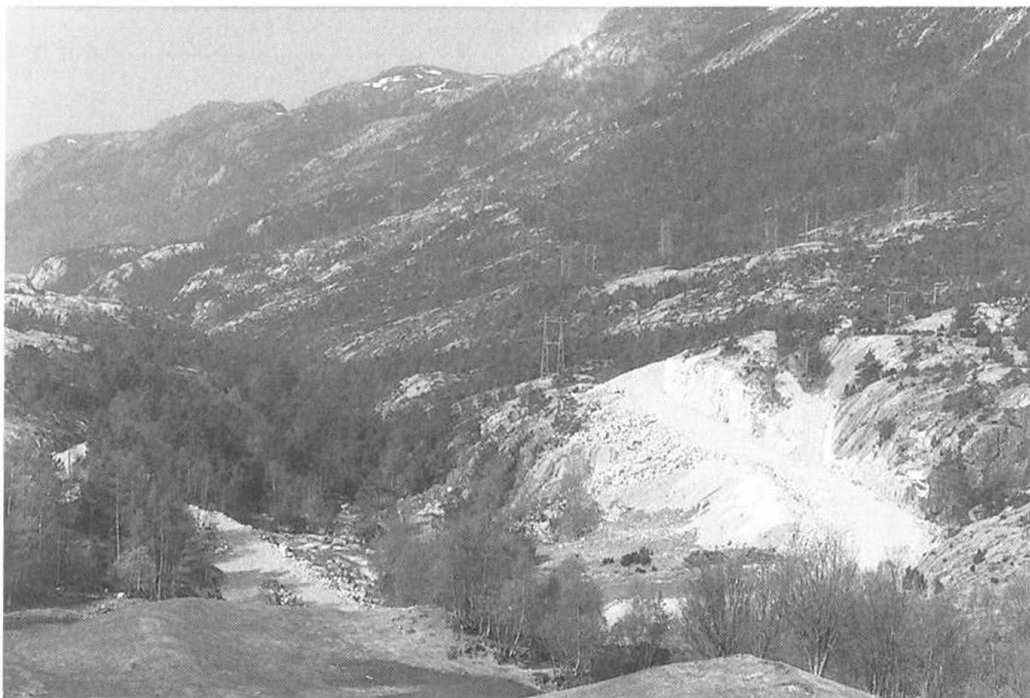
Litt av den grovplanerte vegen ved Helmikstøl. Den nye vegen herfrå til Lyngsvatn blir 11,3 km.
