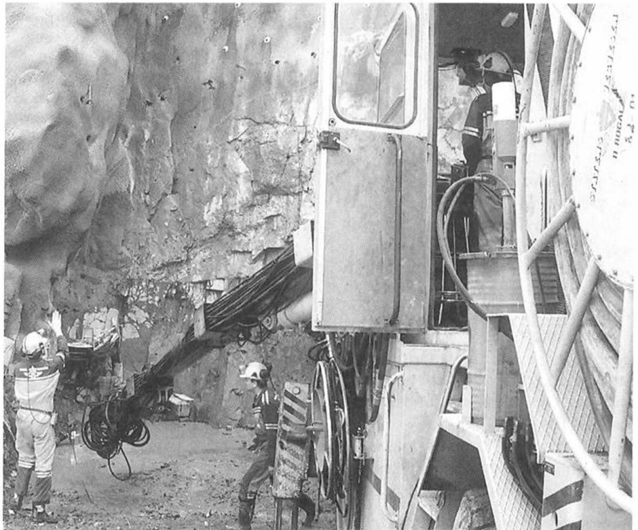
Klart før første boreprogram ved øvre påhogg for den 250 m lange tunnelen frå Nesflaten.
