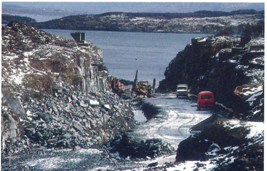
Ned mot Hanasand ferjeleie er det sprengt ut store steinmasser, som m.a. er brukt til ein 125 m lang molo og til oppstillingsplassen. Fotoet er tatt i slutten av mars.
