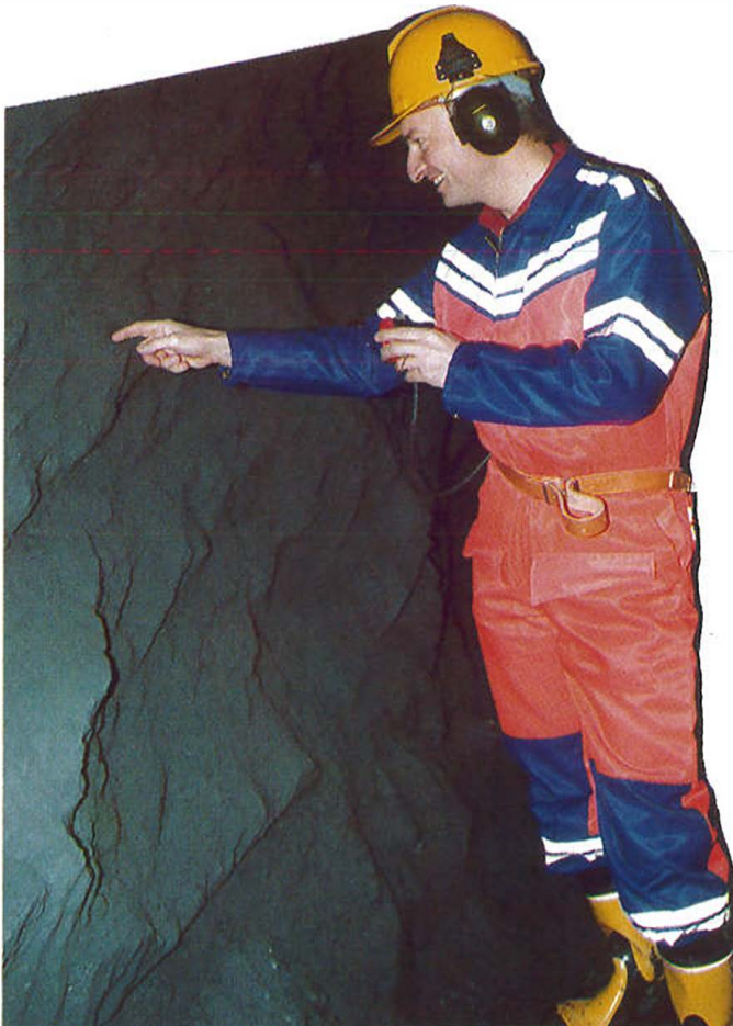
Prosjektleder for Rennfast, Tor Geir Espedal, inspiserer Byfjordtunnelen i en tidlig fase av anleggsperioden. Han er tydeligvis fornøyd med det han ser.
