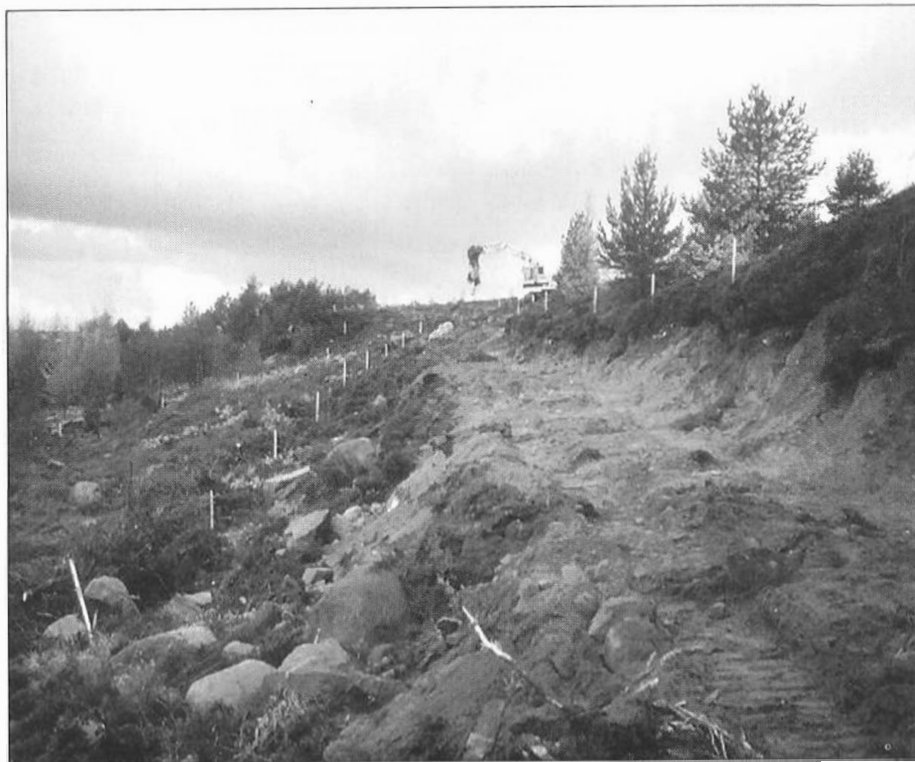
Her i Bogafjell er arbeidet så vidt i gang på den nye motorvegen - E18 Hove - Osil. Frå 1993 startar anleggsarbeidet for fullt. (Foto: Terje Børsheim)
