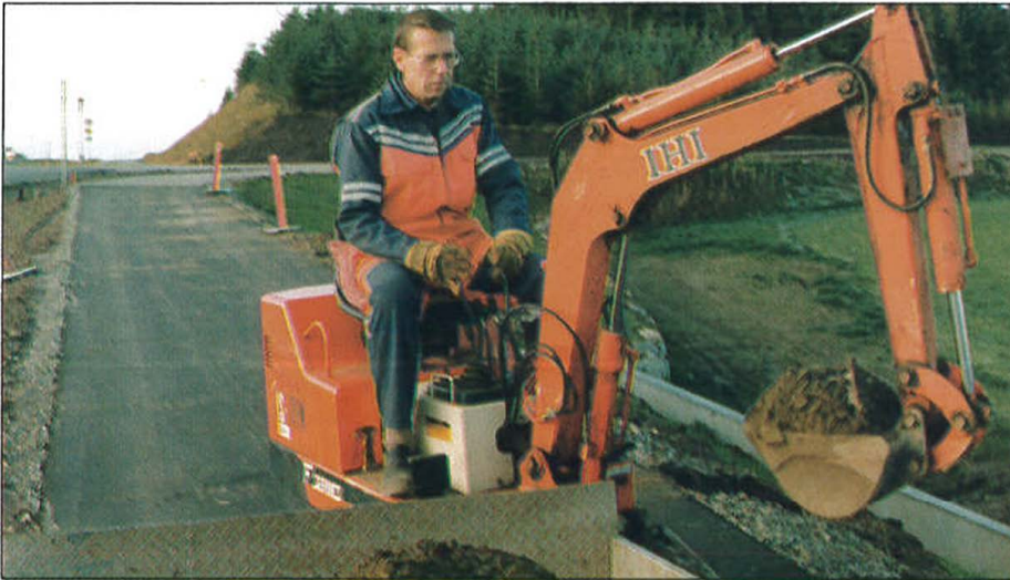
Gaute Vigre i arbeid med finpusseren på den nye gang- og sykkelvegen.
