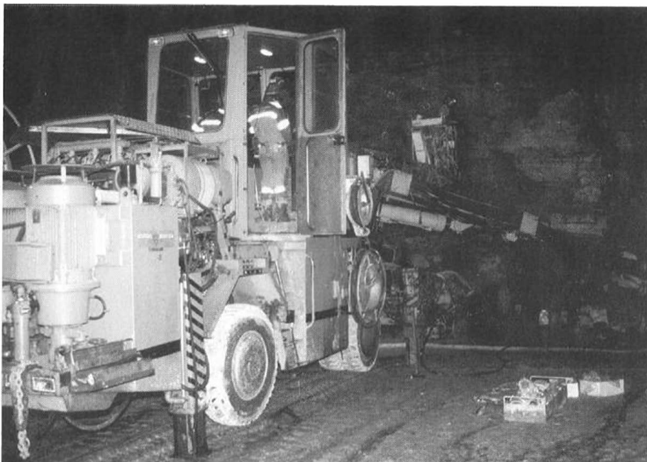
Vedlikehold av undersjøiske tunelar er kostbart. Her frå arbeidet med boreriggen i Mastraffjordtunnelen.
