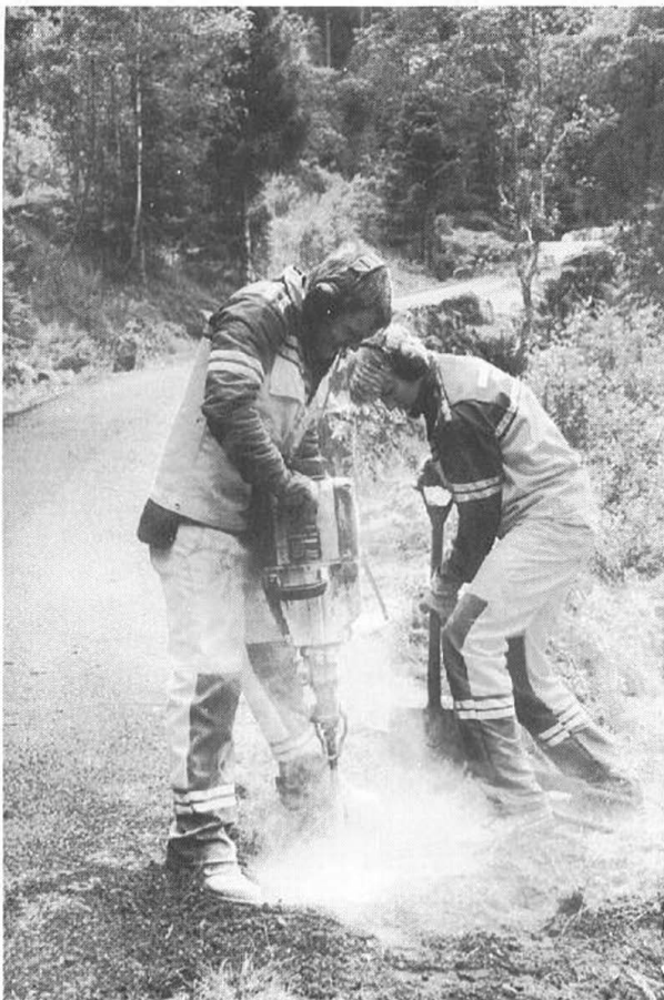
Jonny Røyland i arbeid med boremaskinen og Ole Martin Sollie med spaden. Dei gjer klar til å setta opp stolpar for same typen smijernsrekkverk som tidlegare var langs vegen.
